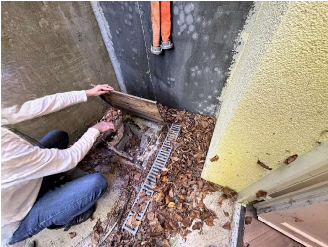
Bild 47 - Lichthof, Entwässerungsrinne, Laubansammlung, Außenwandabdichtung
