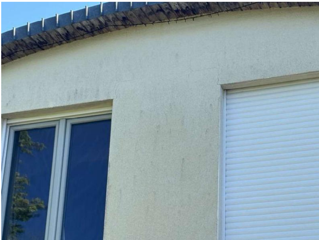
Bild 56 - Fassade, feine Putzrisse
