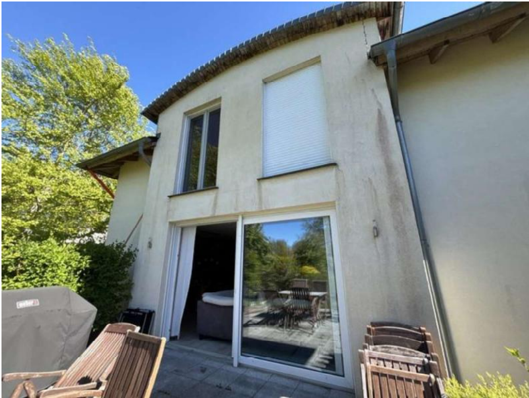
Bild 53 - Ansicht Garten, Terrasse, Fassadenverschmutzung
