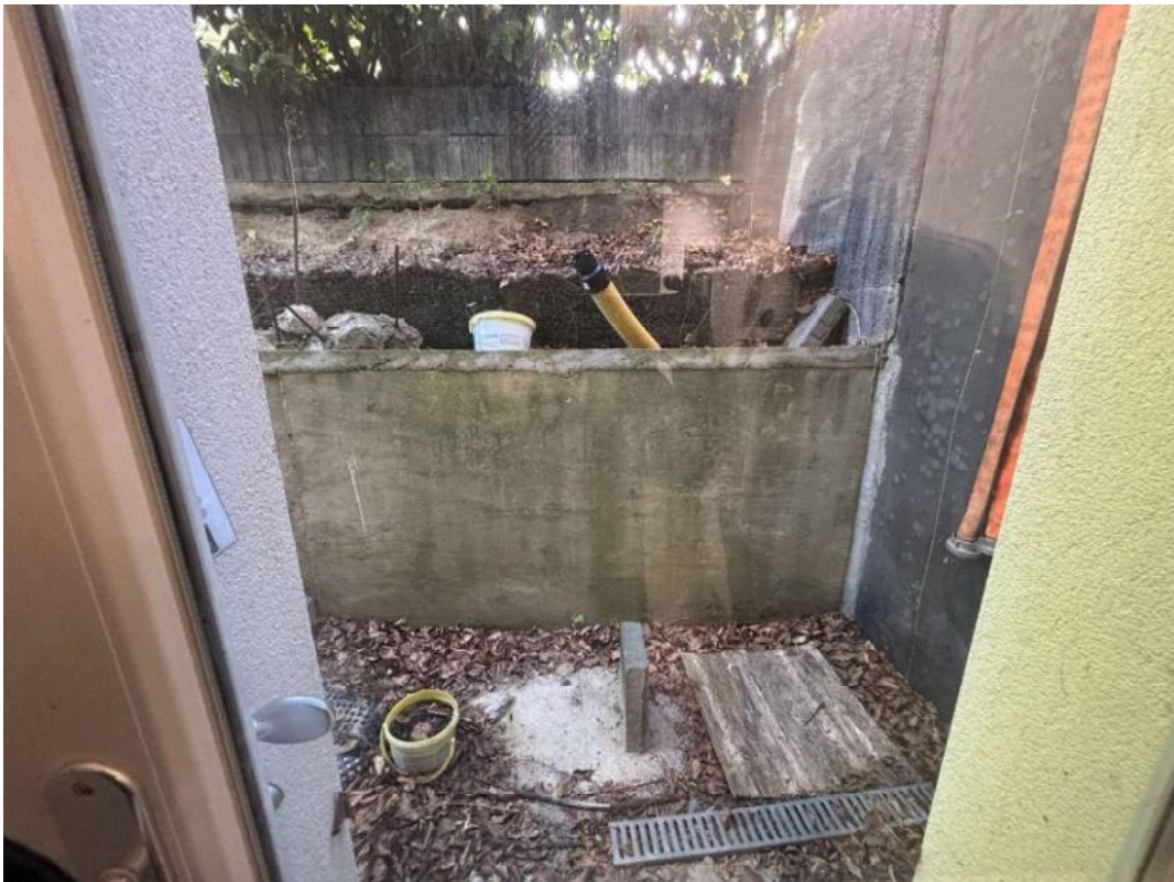
Bild 46 - Lichthof Kellerausgang, Entwässerungsrinne, Laubansammlung
