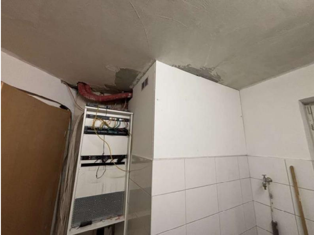
Bild 45 - Hauswirtschaftsraum, Decke Schadstellen
