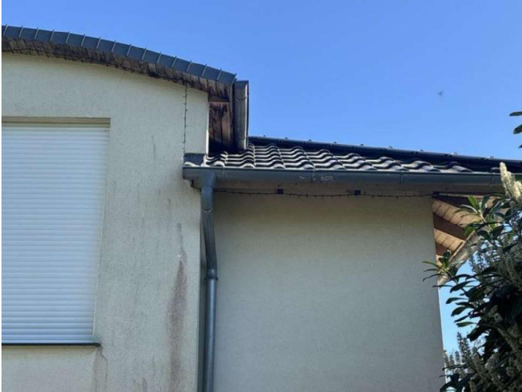
Bild 57 - Fassade, Rissbildung, Fallrohr
