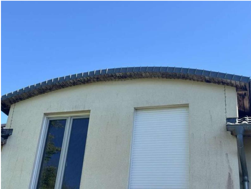
Bild 55 - Fassade Obergeschoss, Traufe, Rissbildung, Verschmutzung
