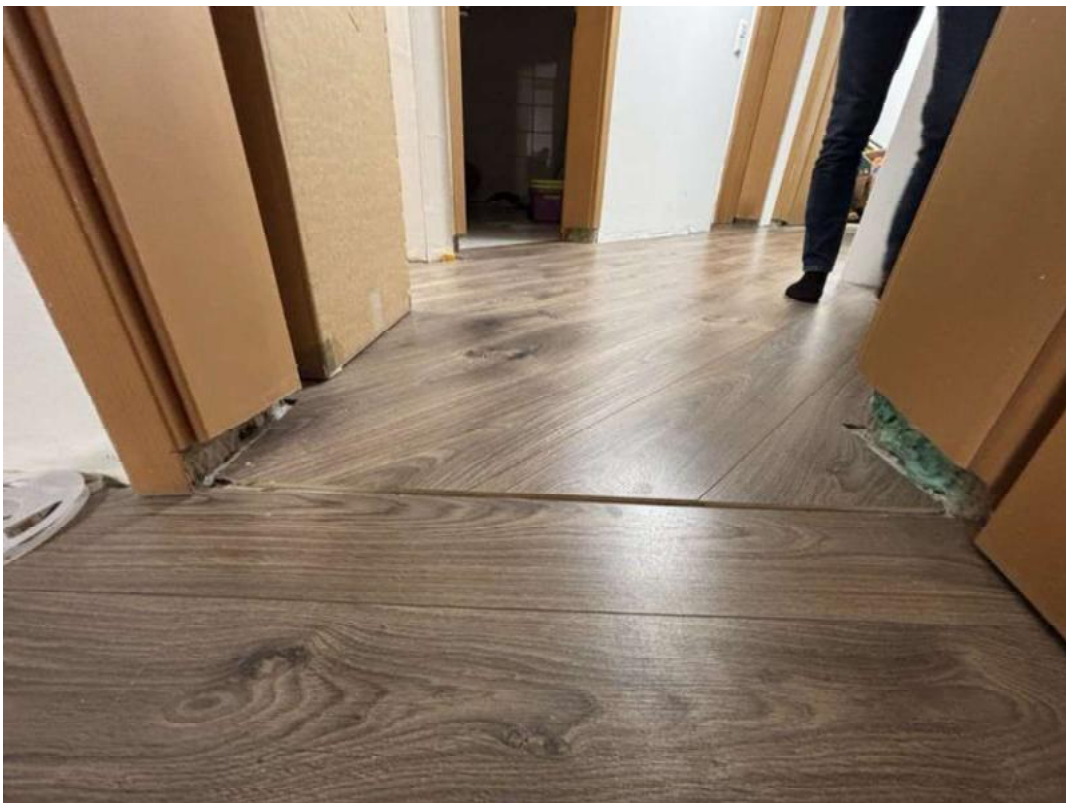
Bild 34 - Flur, Bodenbelag Fugenbildung, fehlende Sockelleisten
