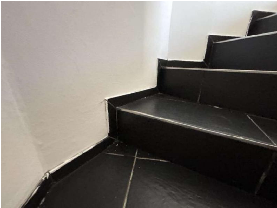
Bild 23 - Treppenhaus, Fuge schadhaft
