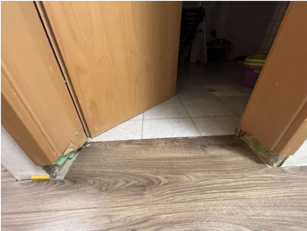
Bild 33 - Türzarge beschädigt, Bodenanschluss, Sockelbereich
