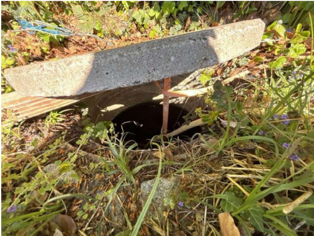
Bild 61 - Kontrollschacht, Abwasser, geöffnet
