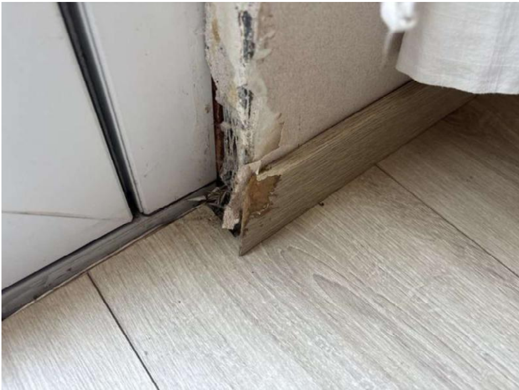
Bild 74 - Schaden Türanschluss, beschädigte Sockelleiste, Feuchtigkeitsschaden
