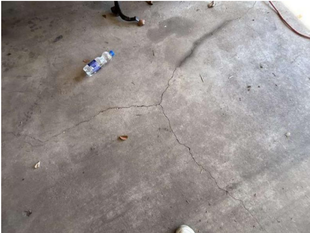
Bild 71 - Riss Bodenplatte Garage
