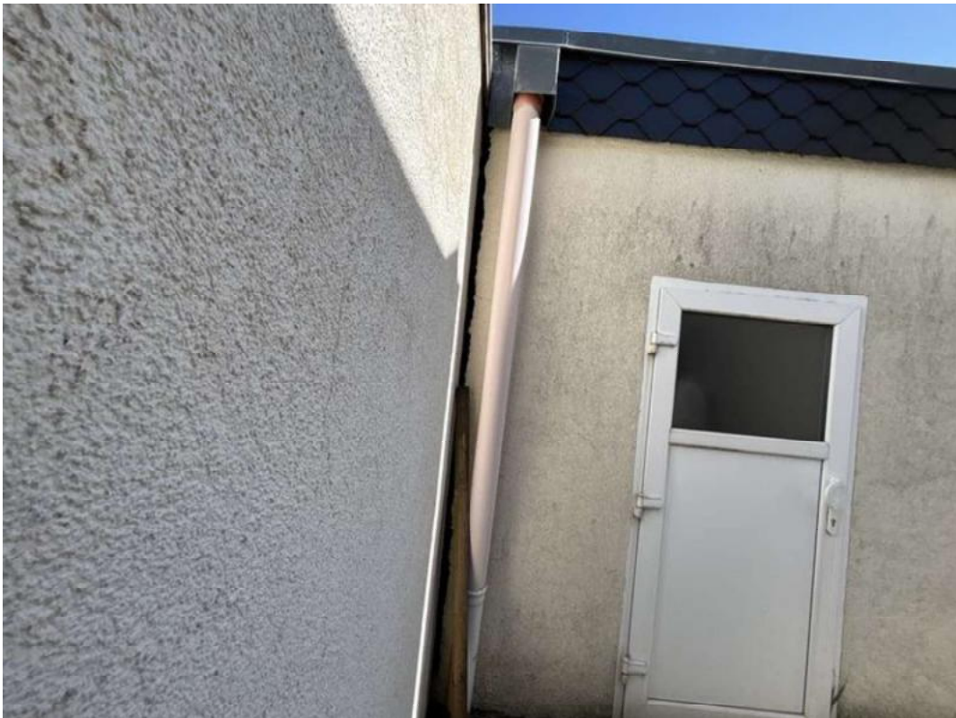
Bild 66 - Gebäudeanschluss, Fuge offen
