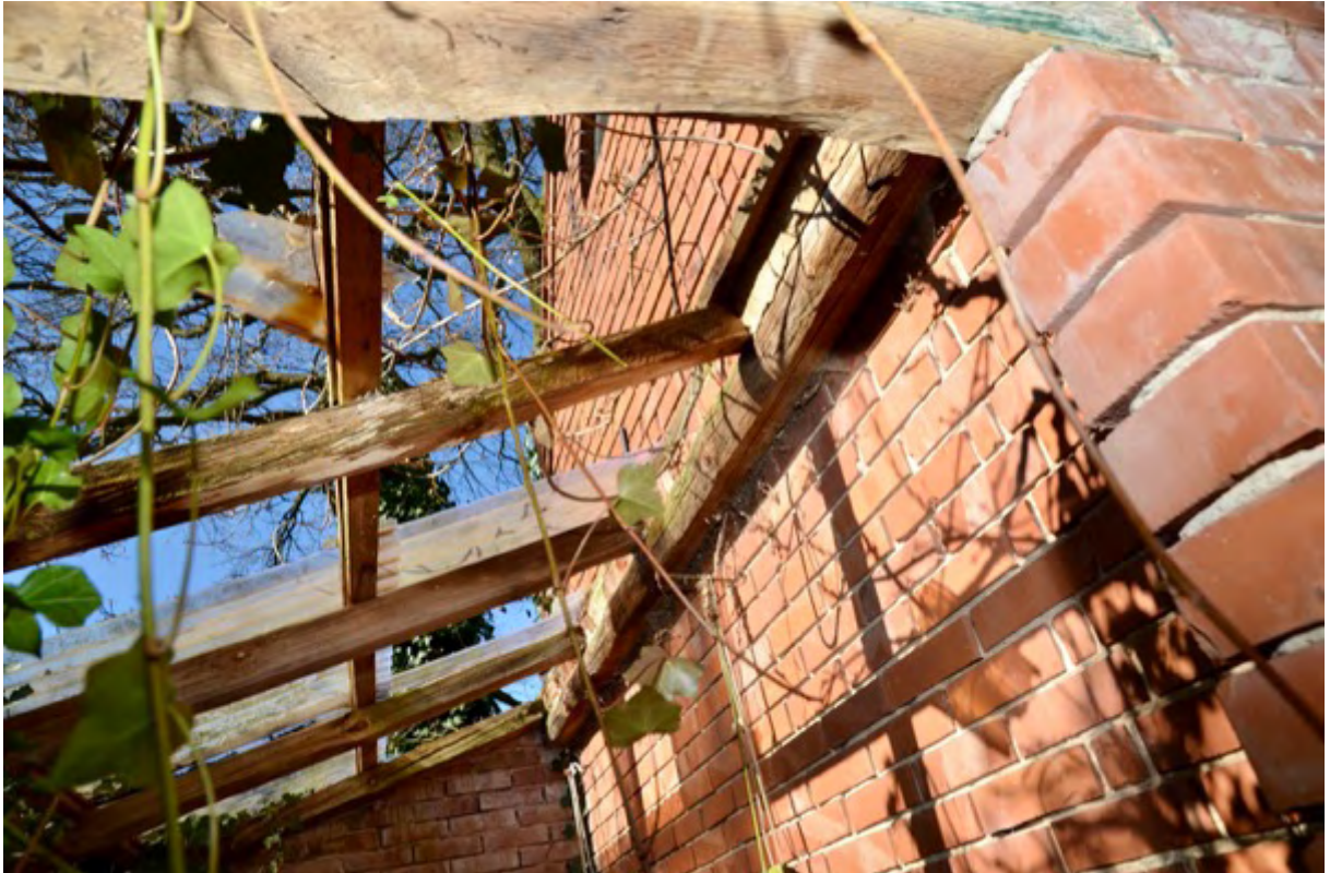
Foto 23 Schadenhafte Dachdeckung und -konstruktion des kleinen, zwar in der Liegenschaftskarte, aber nicht in den Genehmigungsunterlagen enthaltenen Anbaus am südlichen Giebel der Pos. 4
