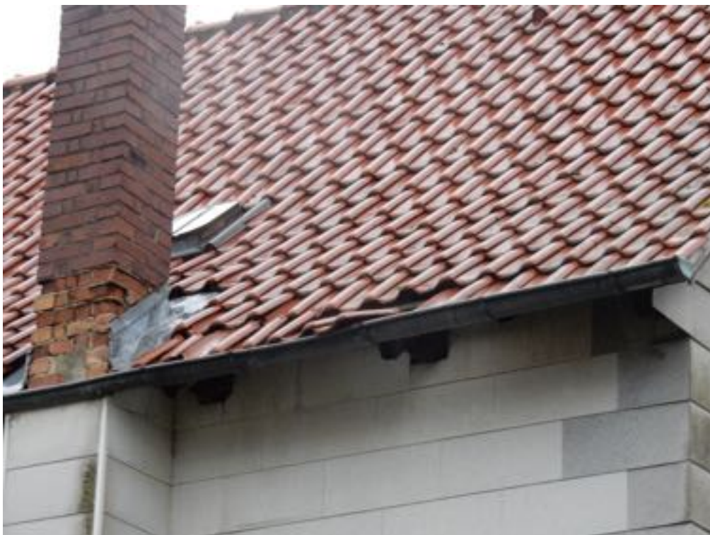
Schäden am Dach und Schornsteinkopf
