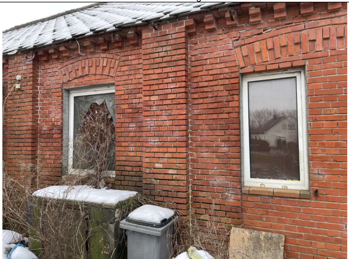
Beschädigtes Fenster / fehlende Verfügung
