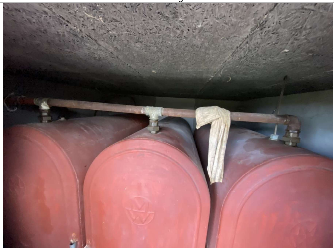
Wohnhaus hinten Erdgeschoss Ölraum
