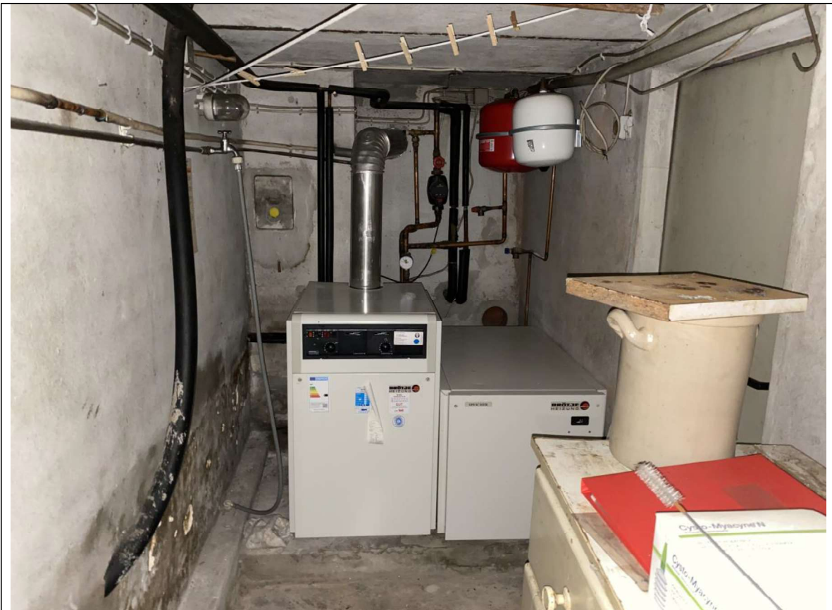
Hochkeller mit Heizung
