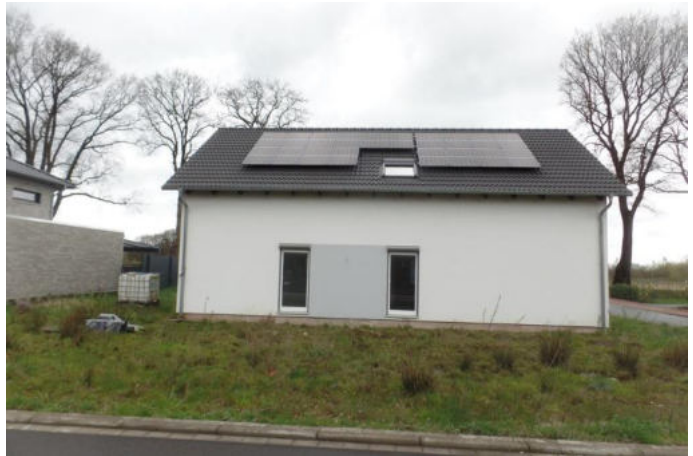
südliche Ansicht mit Photovoltaikanlage
