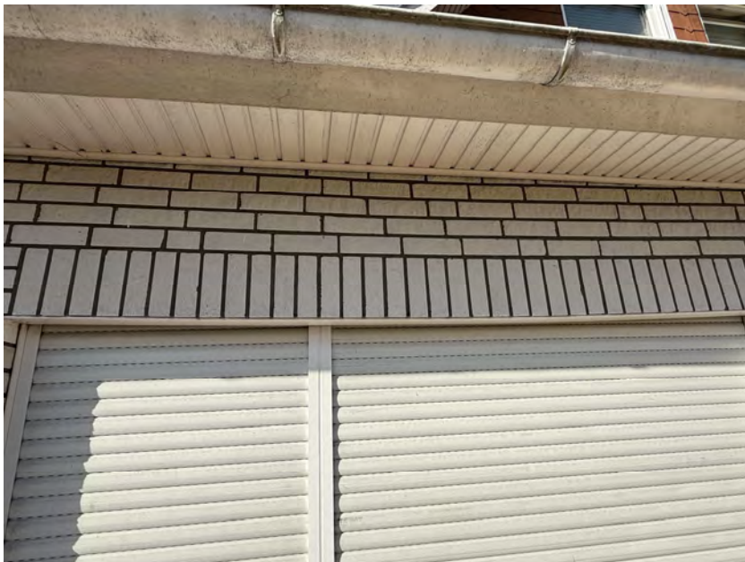
Durchbiegung des Fenstersturzes, Terrasse
