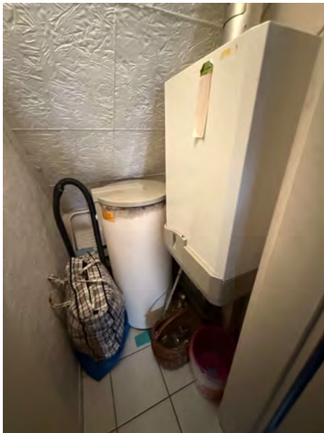
DG Abstellraum Heizungsanlage
