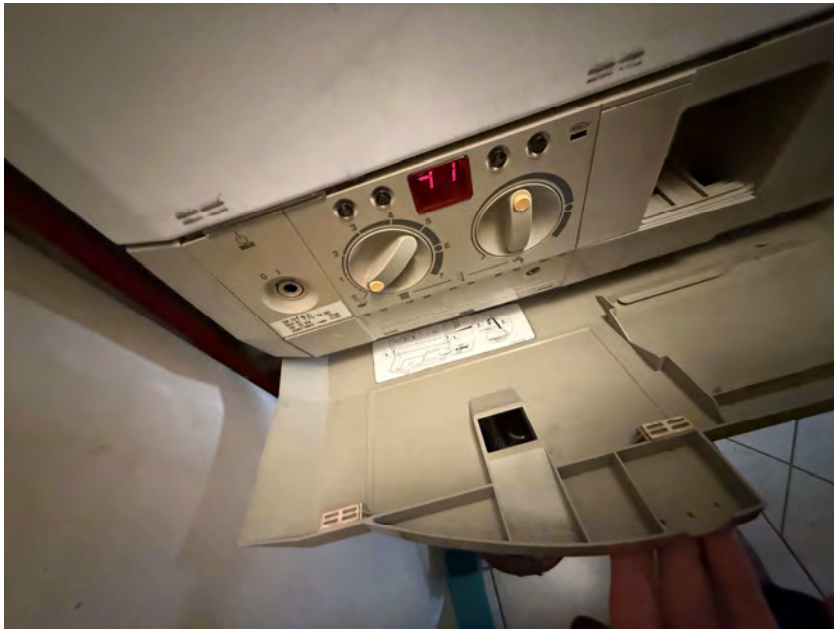
DG Abstellraum Heizungsanlage
