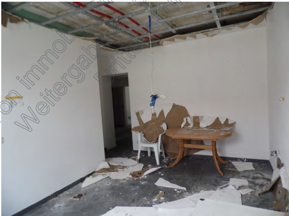
Bild 12: Ausschnitt – Küche mit „Deckenschaden“ Richtung Flur
