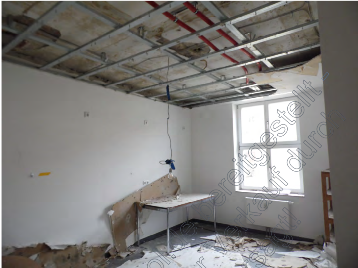
Bild 11: Ausschnitt – Küche mit durch Wasser verursachten „Deckenschaden“ (Westtrakt Wohnanlage Nelkenhof Wohnung Nr. 4 EG).
