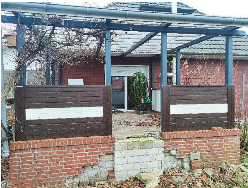
überdachte Terrasse an der Gebäudenordseite in schlechtem baulichem Zustand
