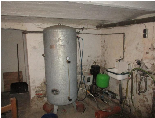
Druckerhöhungsanlage für das gesamte Objekt
