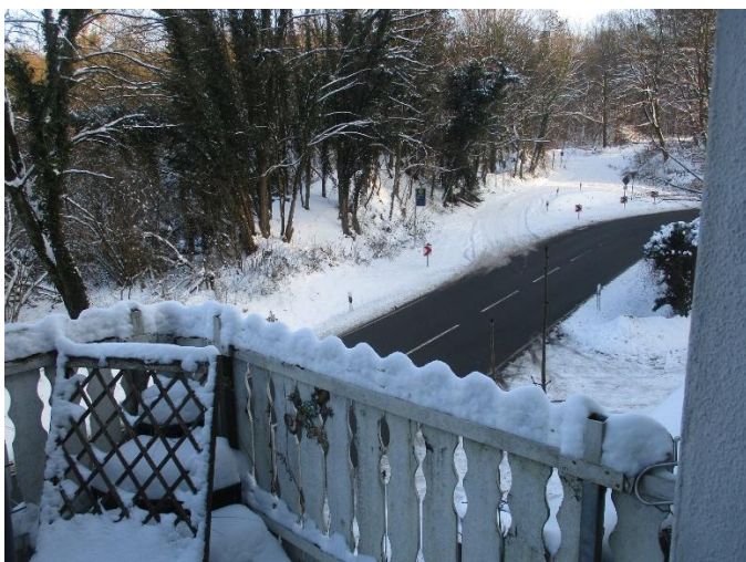
Balkon, Geländer abgängig
