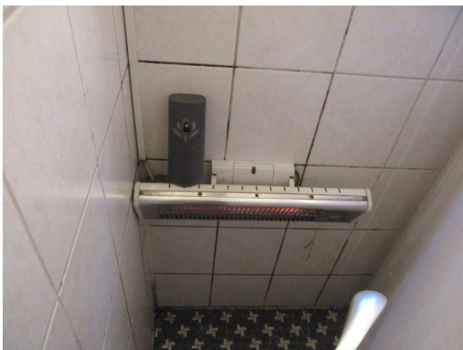
Heizstrahler in WC
