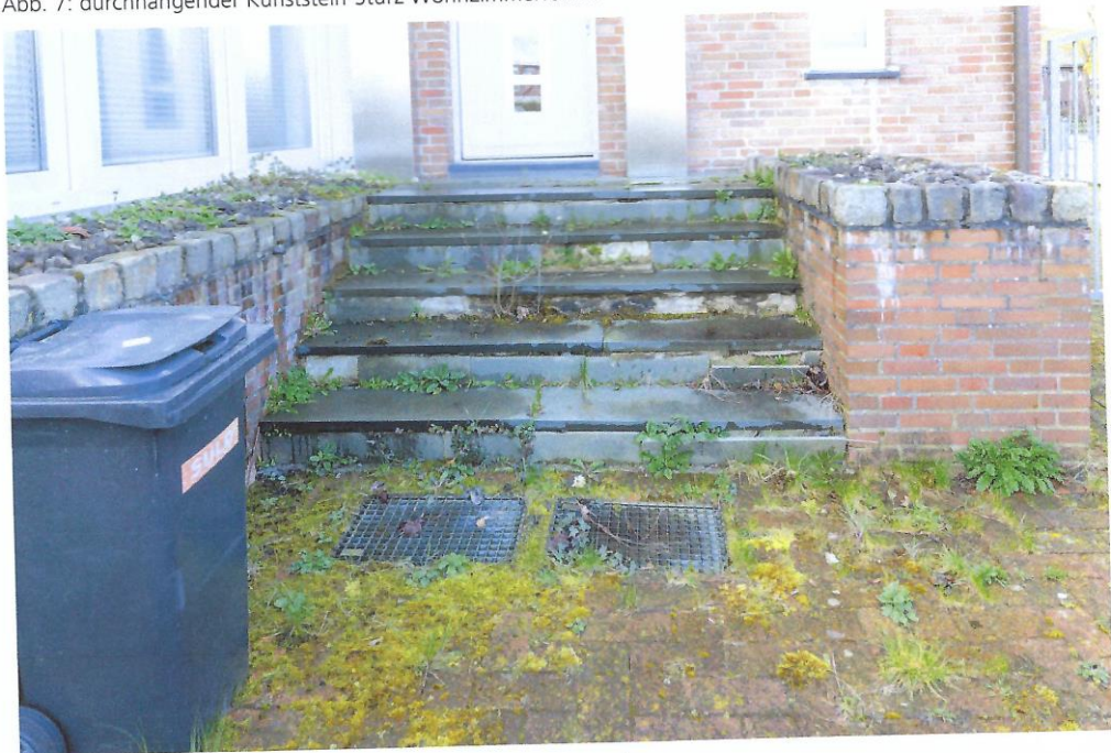
Abb. 8: Außentreppe gartenseitig (bedarf einer Kernsanierung)
