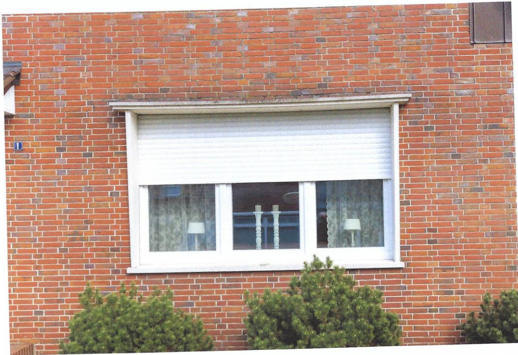
Abb. 7: durchhängender Kunststein-Sturz Wohnzimmerfenster
