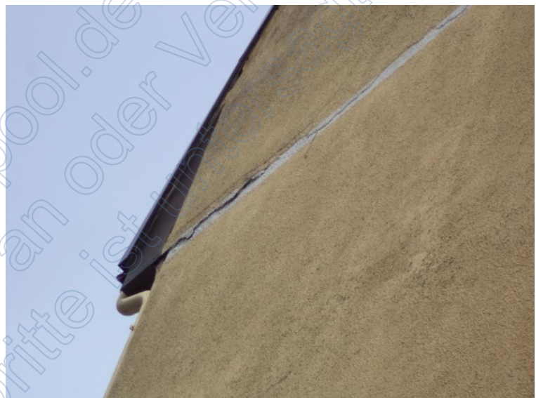
Detail Giebelansicht Risse
