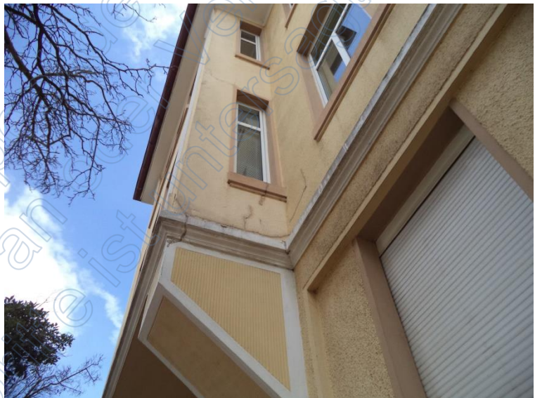
Detail Straßenansicht (Bodenstedtstraße) Erker, sanierte Risse
