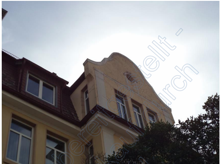
Detail Straßenansicht (Bodenstedtstraße) Giebel, sanierte Risse
