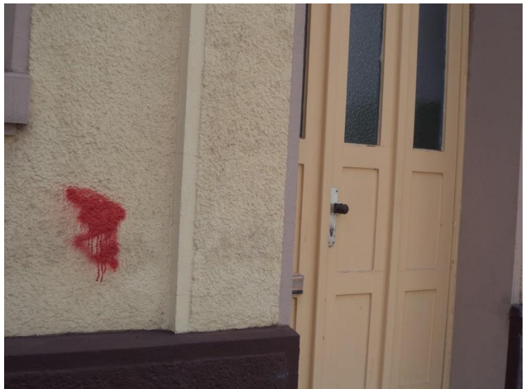
Detail Straßenansicht (Bodenstedtstraße) Hauseingang, Fassadenver- schmutzung
