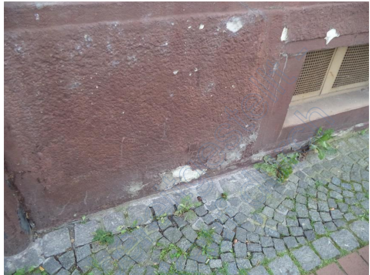
Detail Straßenansicht (Bodenstedtstraße) Putzabplatzungen
