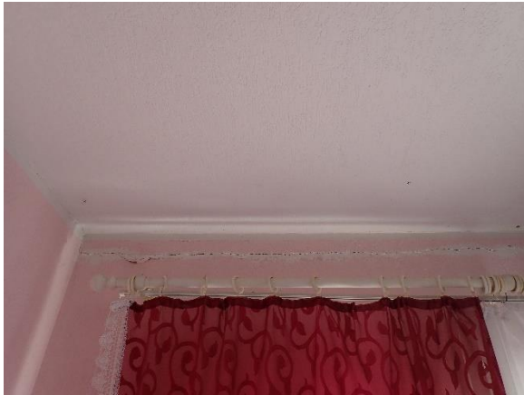
Wandrisse Zimmer 3 EG (Anbau)
