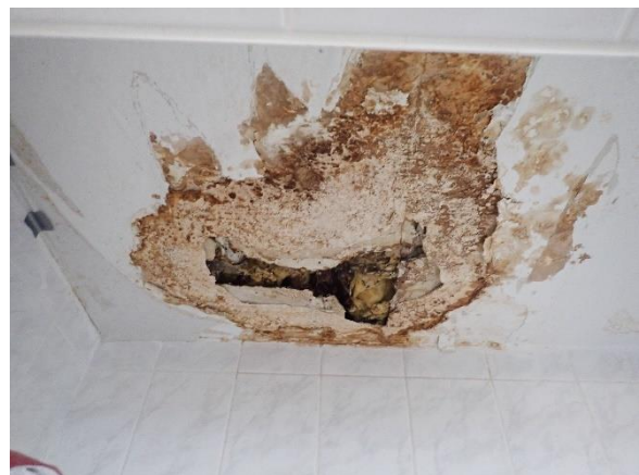
Feuchtigkeitsschaden Bad Wohnung 2 (EG)
