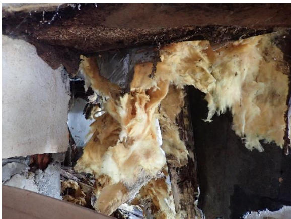
Bauschäden Abstellraum 2 UG (Anbau)
