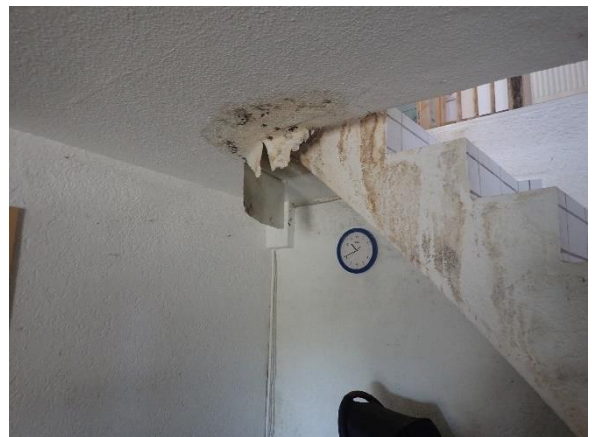
Feuchtigkeitsschaden Treppe UG (Anbau)
