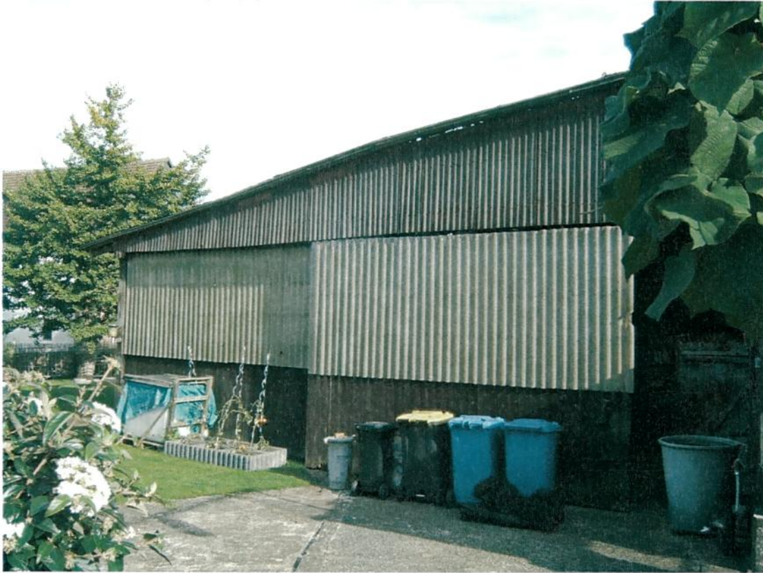
Foto 4, Rückansicht abgängige ehem. Maschinenhalle
