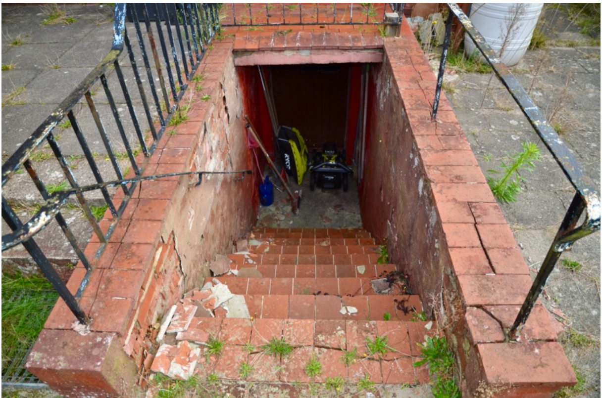
Foto 6 Schäden an rückwärtiger Kelleraußentreppe
