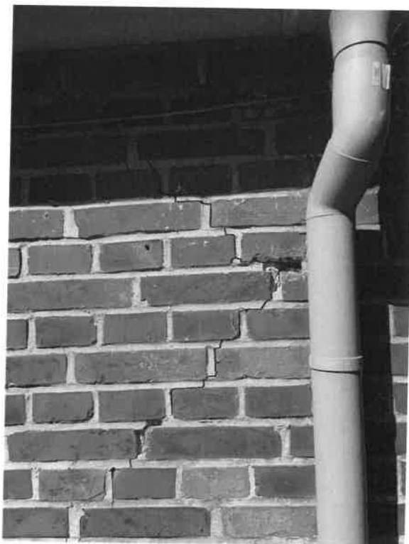
Risse im Mauerwerk
