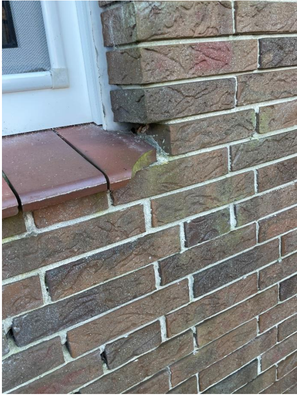
Schäden an Fensterbank
