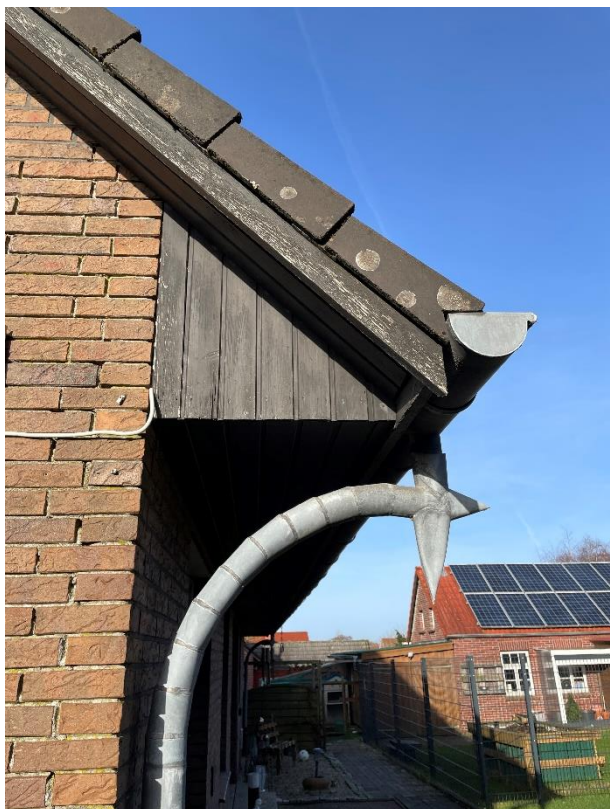
Fehlende Verfugung Mauerwerk
