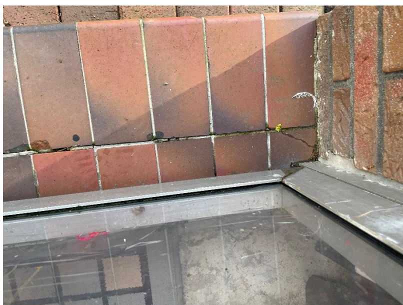
Schäden an Stufe zur Garage
