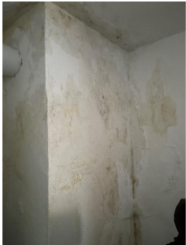
Durchfeuchtung des Schornsteins
