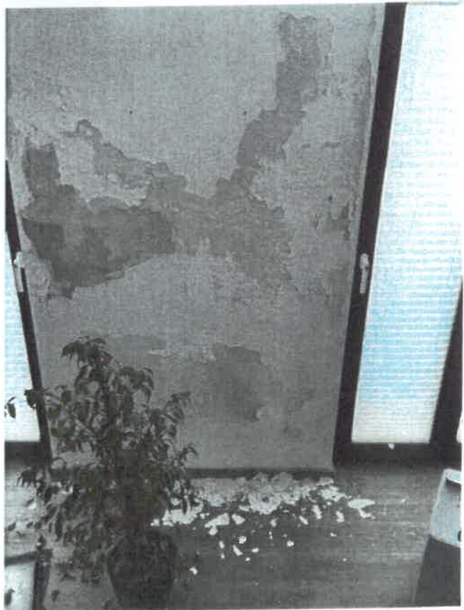
Schäden an Anstrich innerhalb Tagespflege (Leerstand)
