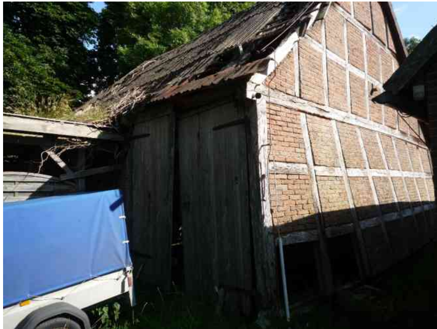
abgängige Remise/Schuppen, Südwestansicht
