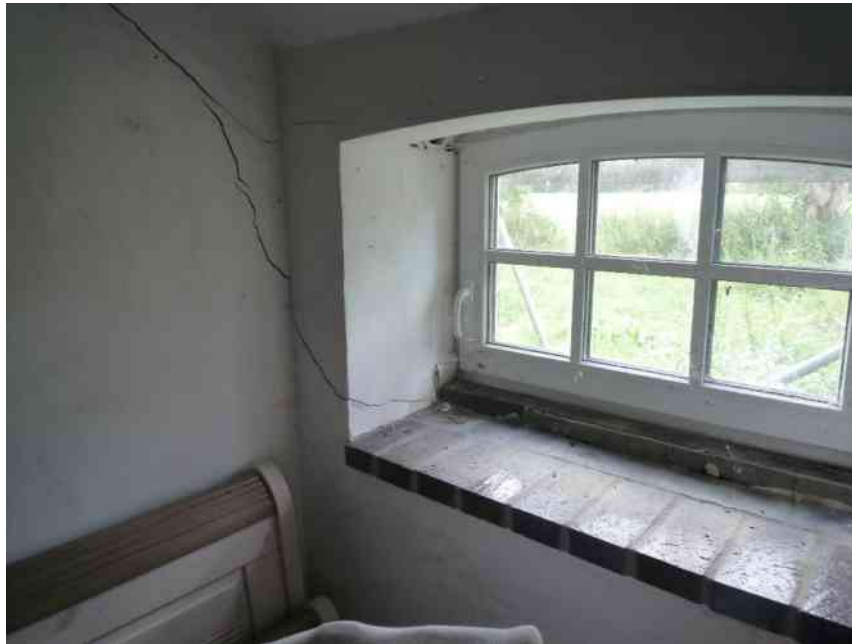
Riss un Absackung im Bereich der Einliegerwohnung
