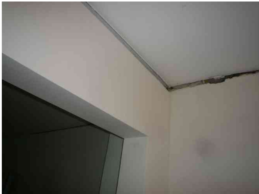
Riss im Schlaftrakt
