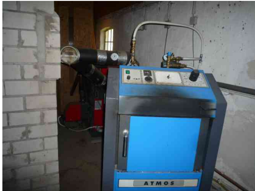
Heizungsraum im Wirtschaftsteil
