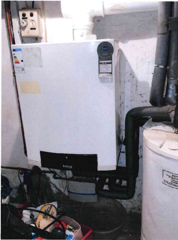
Heizungsraum im Keller
