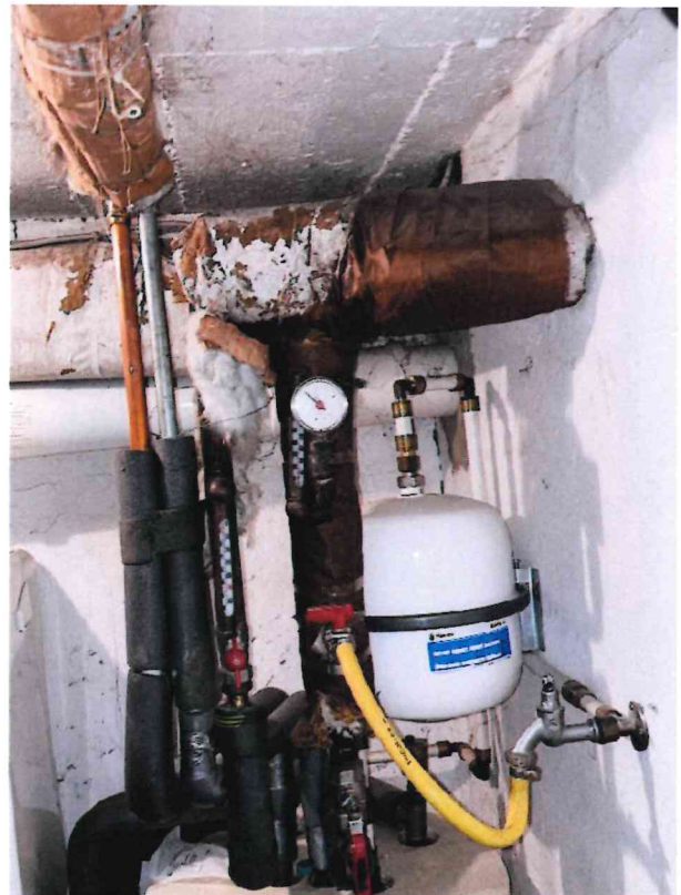
Heizungsraum im Keller
