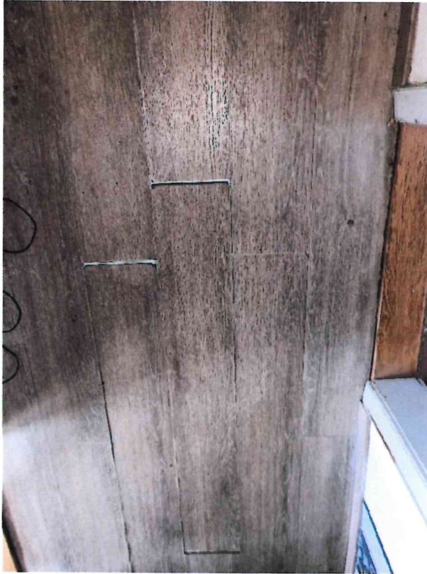
Beschädigter Bodenbelag im Flur
