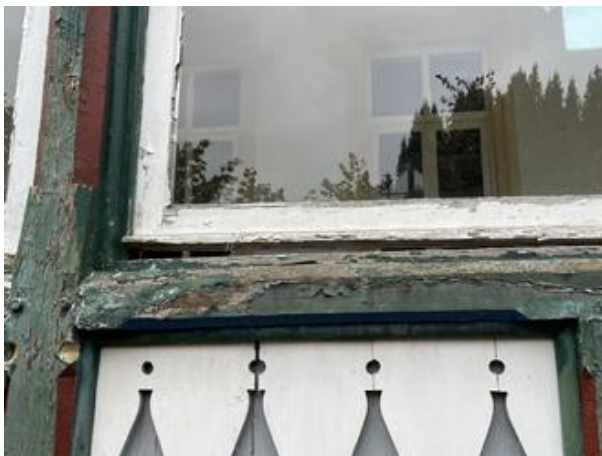
Beispielhaft für den Zustand der Holzkonstruktionen im gesamten Objekt
