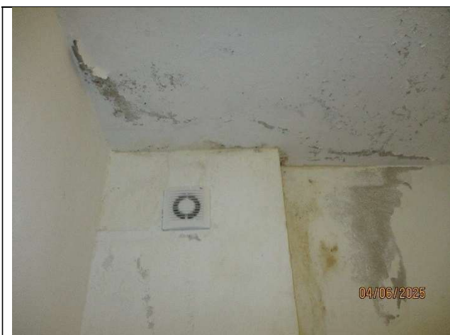
Feuchtigkeit im Bad
