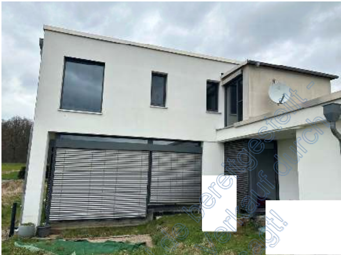
Bild 05: Blick auf die zweigeschossige Südseite des Einfamilienhauses . Rechts schließt sich der eingeschossige Teilbereich an. Oben rechts ist der Schlafzimmervorbau ohne die ebenfalls fehlende Holzbekleidung zu sehen.
