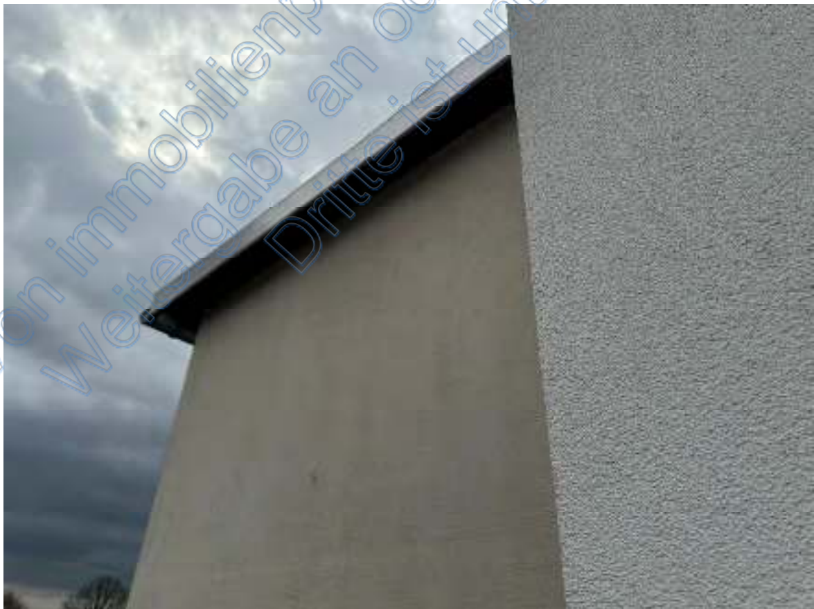
Bild 25: Blick auf die Fassade des Schlafzimmervorbaus (ohne die fehlende Holzbekleidung).
