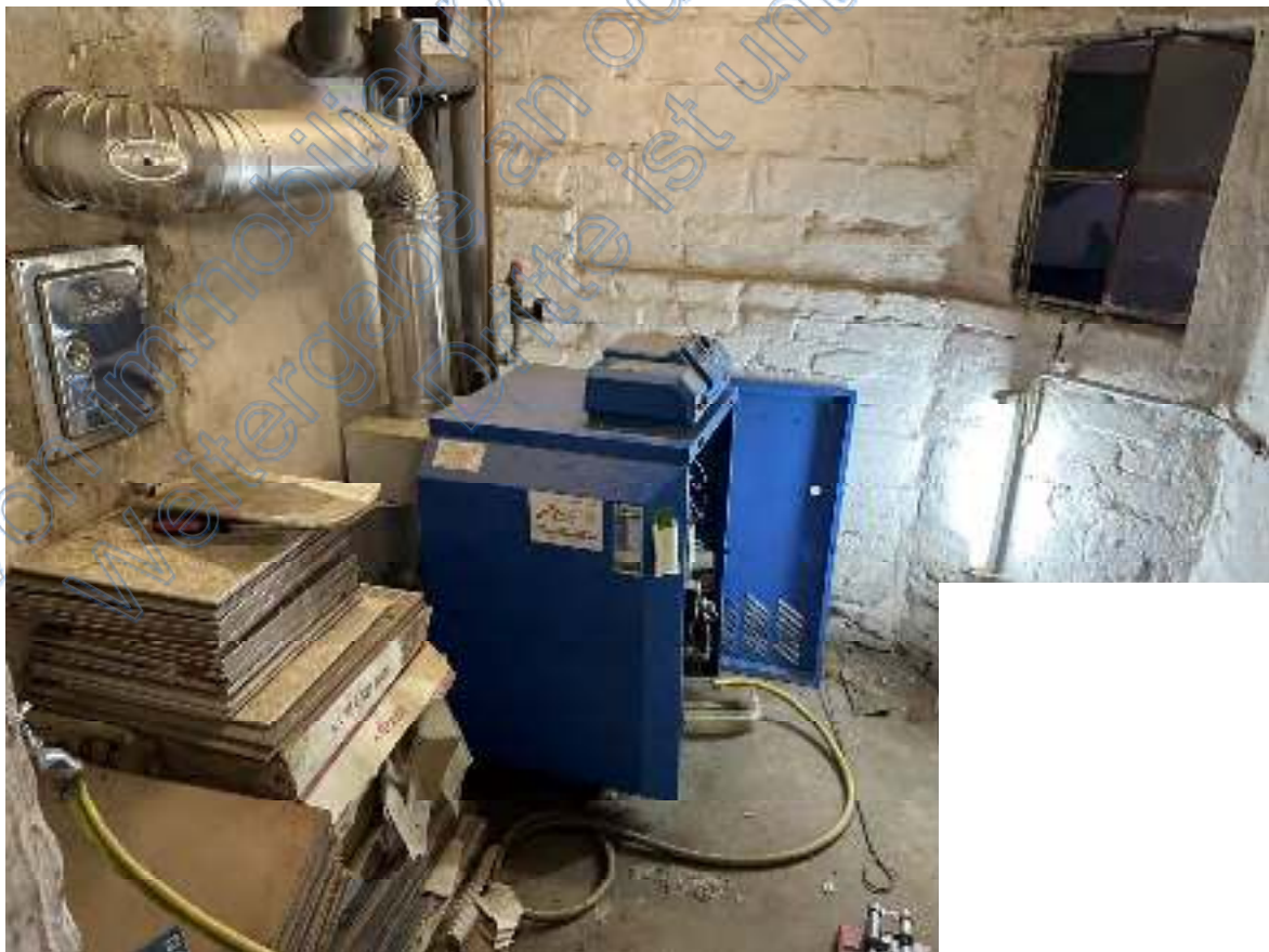
Bild 38: Ausschnitt – Heizungsraum (Wohnhaus KG).
