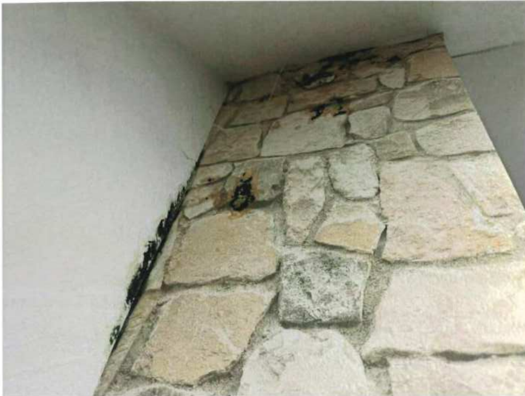
Bild 4: Tapezierter Schornstein mit Verfärbungen und Ablösungen
