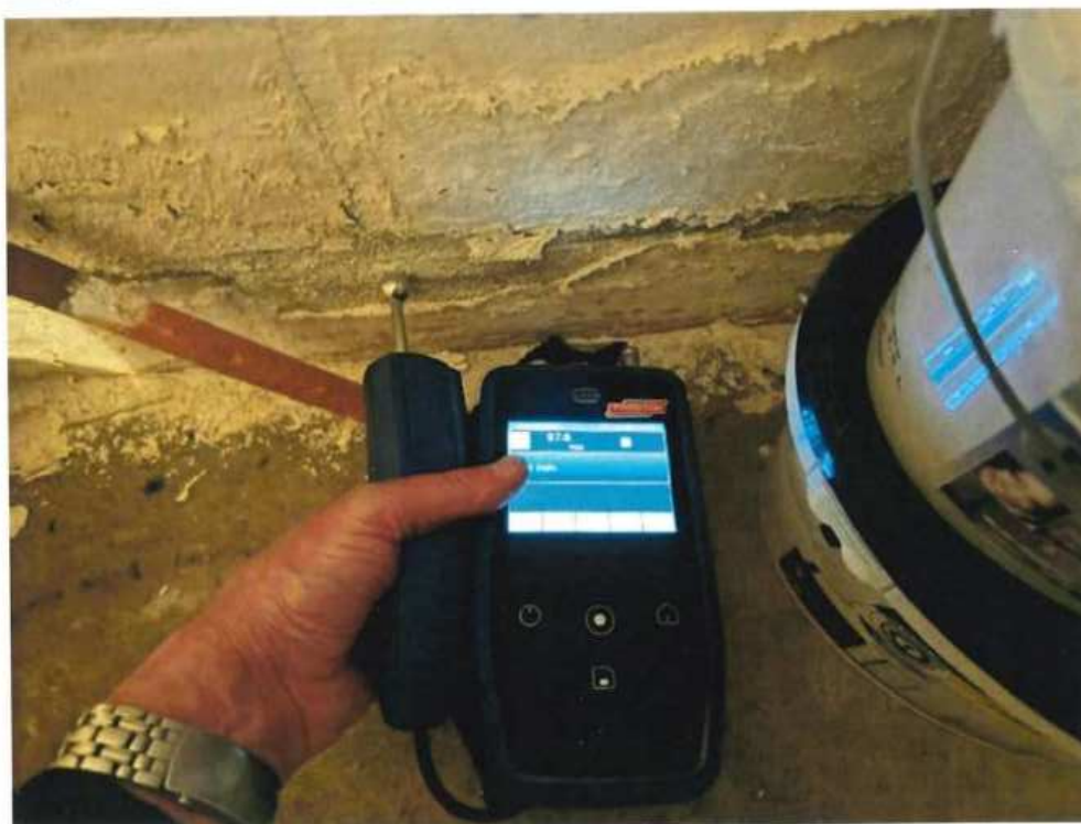
Bild 19: Hohe Bauteilfeuchte im unteren Wandbereich des Heizungsraumes
