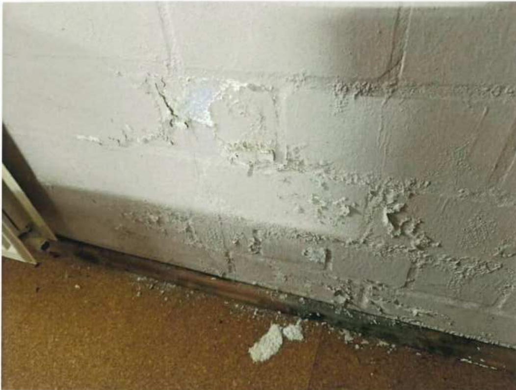
Bild 15: Kelleraußenwand mit Farbabplatzungen, Schimmelbildung an der Fußleiste
