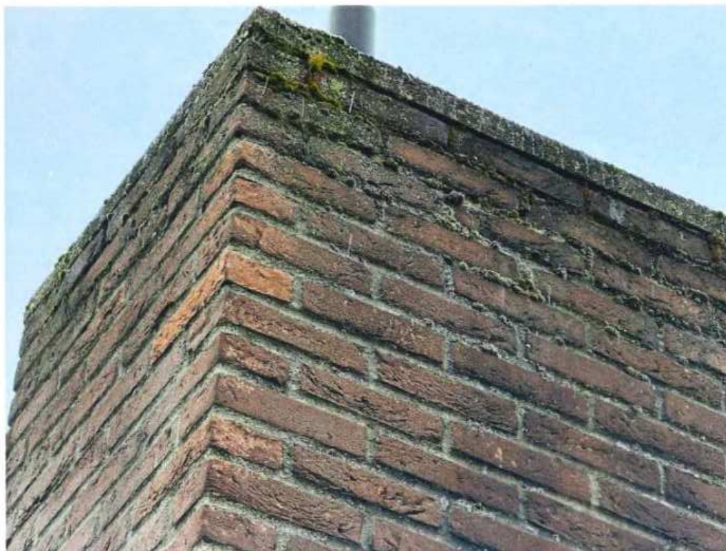
Bild 8: Schornsteinkopf stark verwittert, ausgebrochene Fugen, Moosbildung
