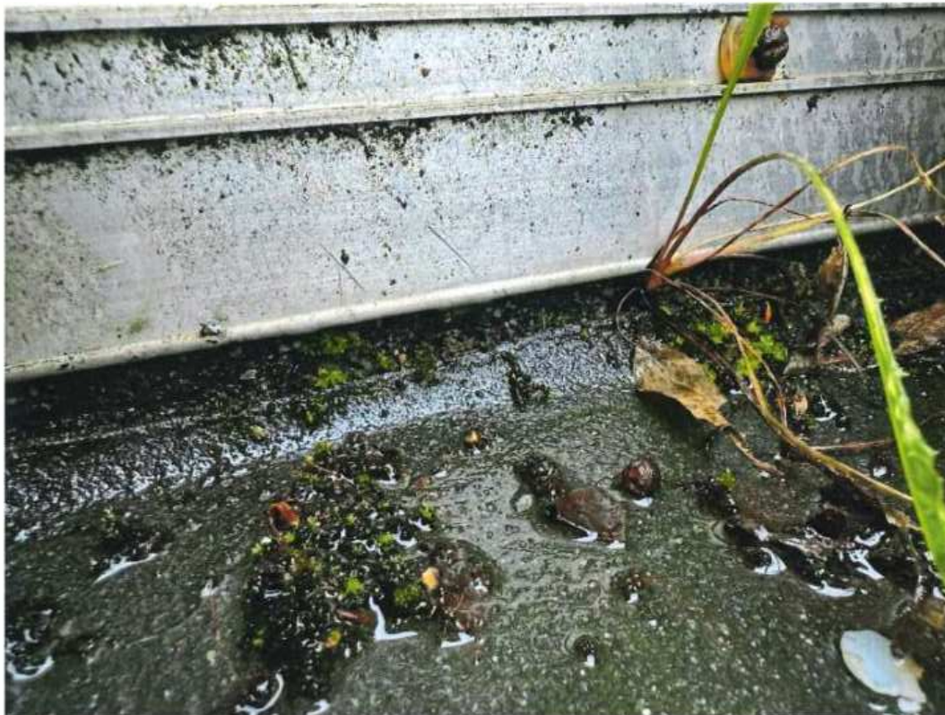
Bild 14: Obere Lage Abdichtung, nicht hinter Kappleiste geführt, Bewuchs im Anschluss
