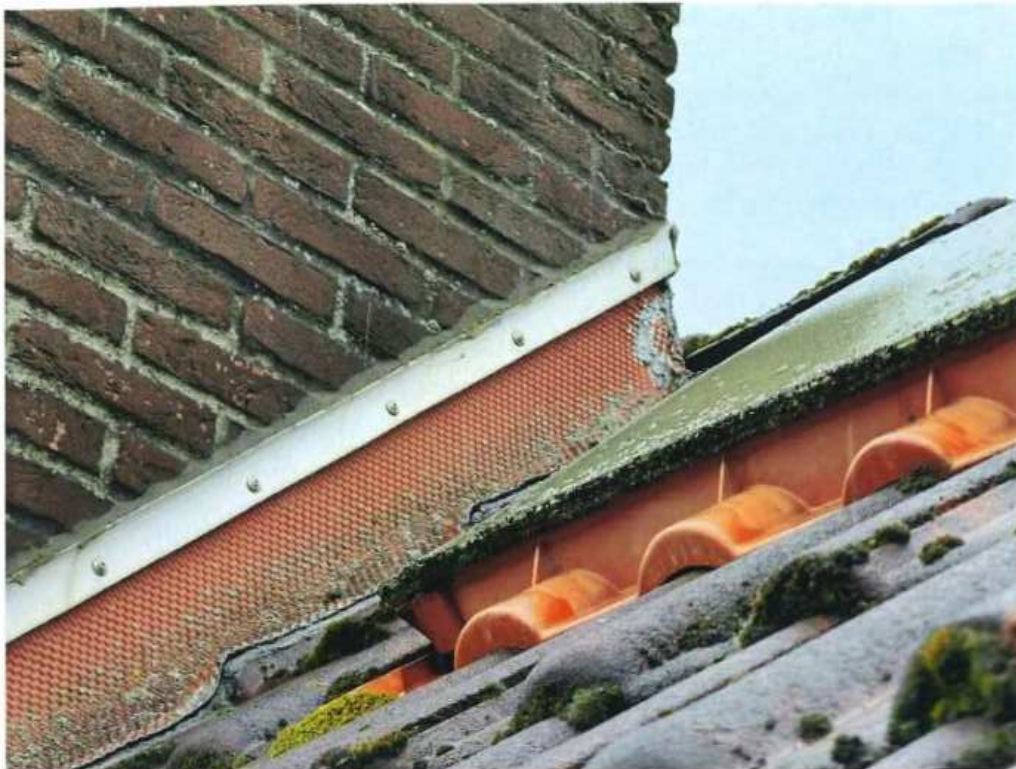
Bild 7: Seitlicher Anschluss Abdichtung (Verwahrung), verwittertes Mauerwerk
