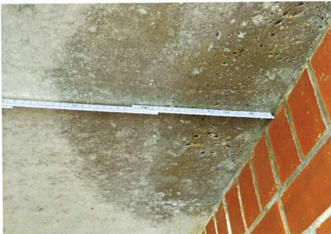
Bild 11: Detail zu Bild 10, Durchfeuchtung Balkonplatte
