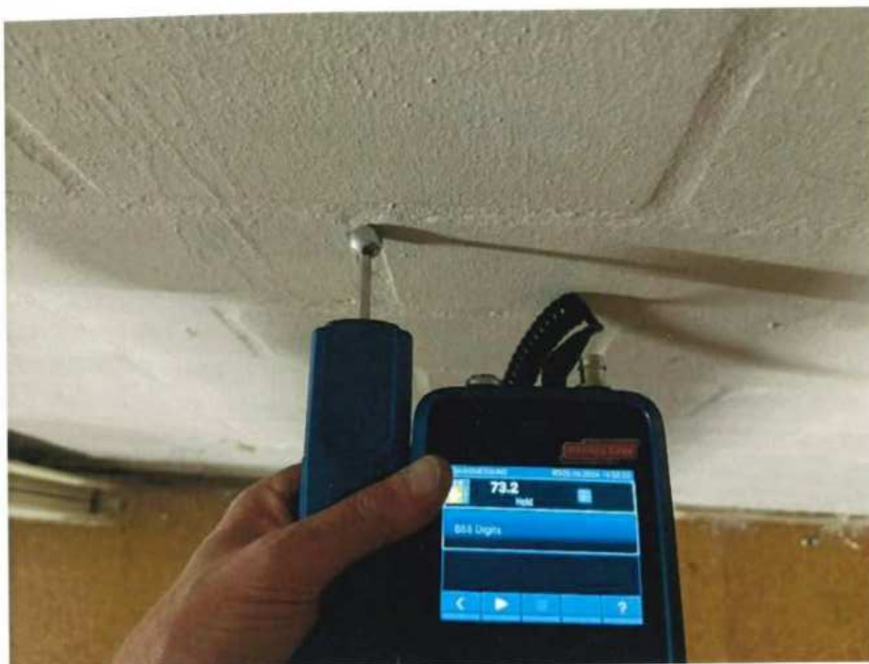
Bild 18: Feuchtemessung in ca. 1 m Wandhöhe
