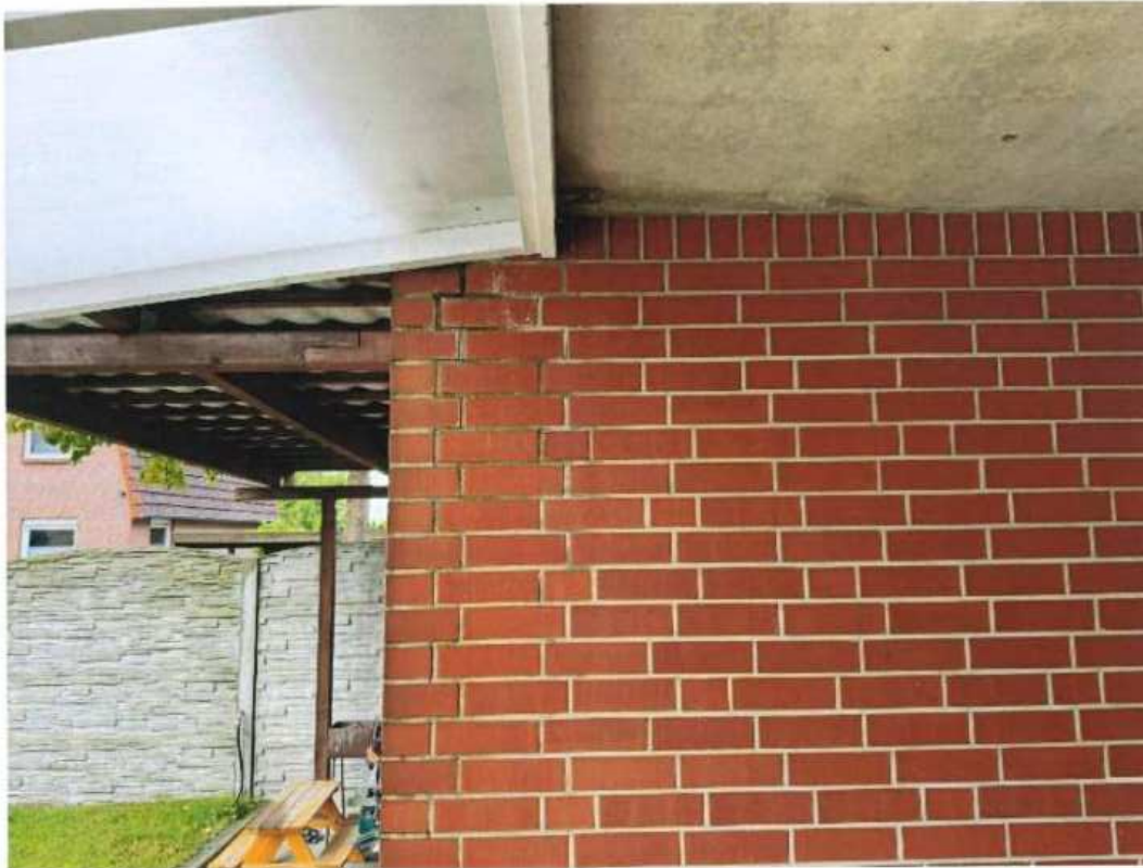
Bild 12: Durchfeuchtungen linke obere Wandecke Trennwand zum Giebel
