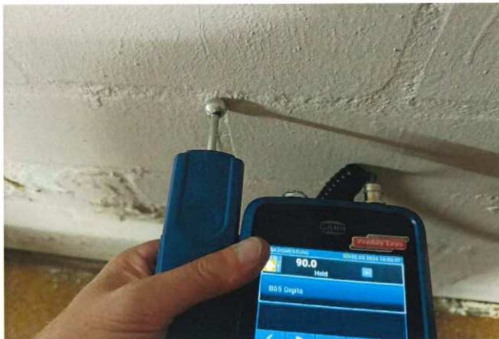
Bild 17: Feuchtemessung in ca. 50 cm Wandhöhe
