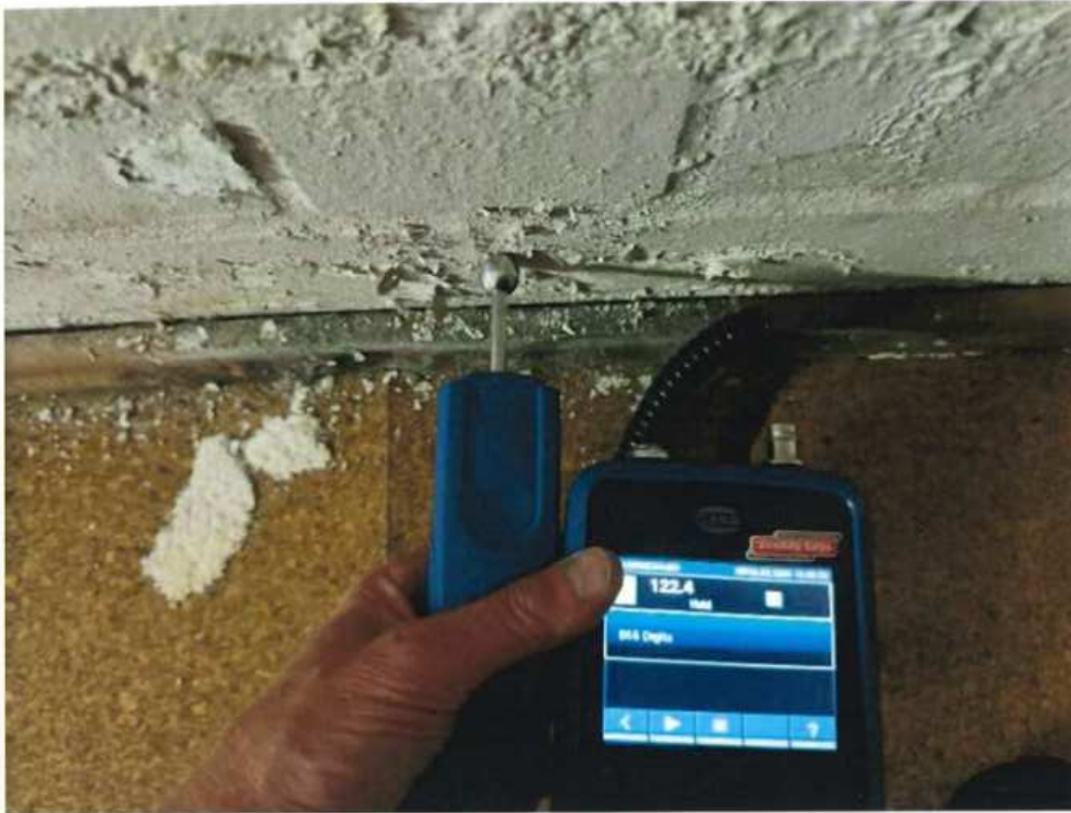
Bild 16: Sehr hohe Bauteilfeuchte im unteren Wandbereich
