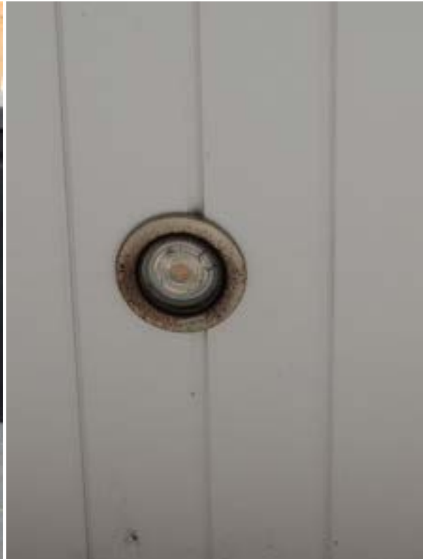
Einbauleuchten am Dachüberstand korrodieren
