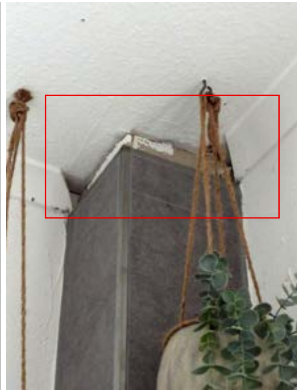
WC | Wandfliesenbelag nicht fertig gestellt
