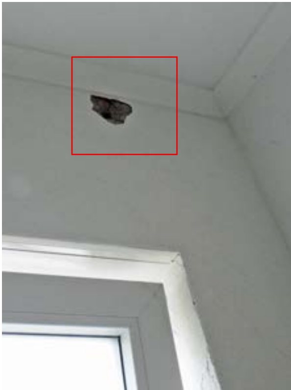
WC | Schaden in der Außenwand
