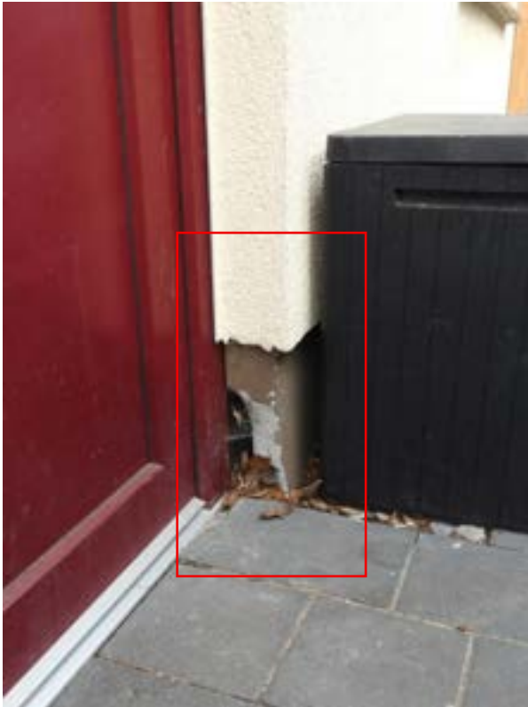
Schaden im Sockelbereich auf der Ostseite
