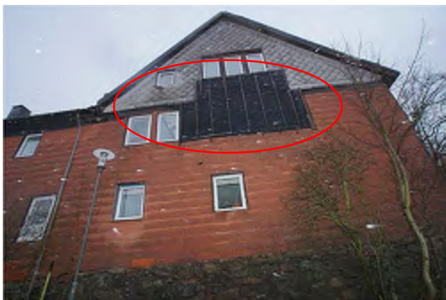
Bild Nr.: 3 Provisorischer Fassadenverschluss. Fassadenbehang defekt.
