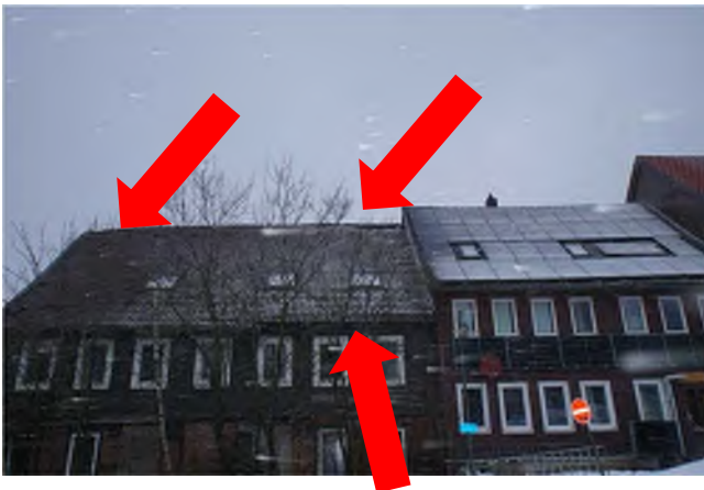
Bild Nr.: 6 Dachundichtigkeiten im Firstbereich. Defekte Traufe.
