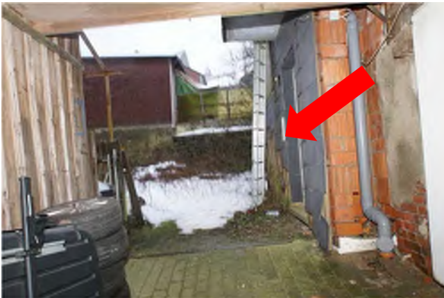
Bild Nr.: 11 Fassadenbehang defekt.
