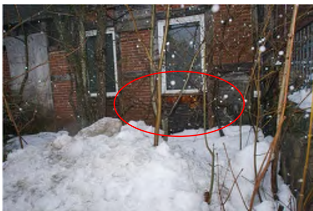
Bild Nr.: 8 Fehlstelle unter Fensterbrüstung.
