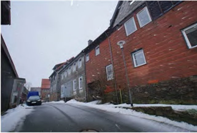
Bild Nr.: 4 Fassadenbehang defekt.
