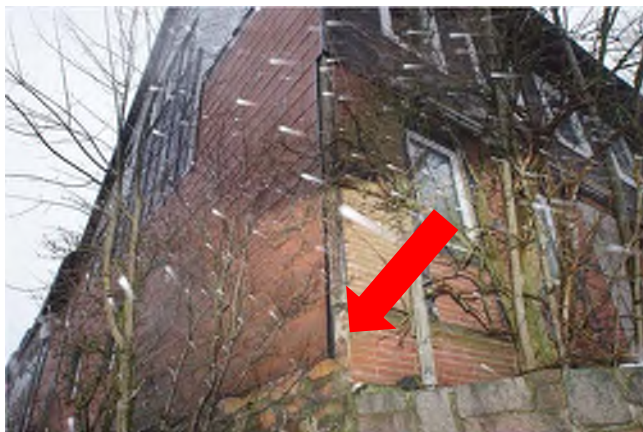
Bild Nr.: 7 Abgängige Eckstütze Fachwerk.
