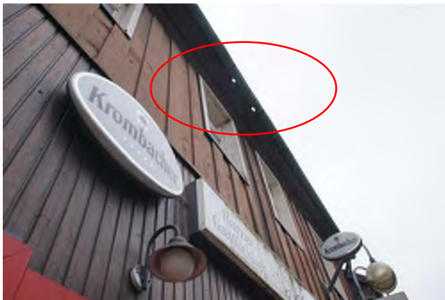
Bild Nr.: 11 Straßenseite Dachundichtigkeiten
