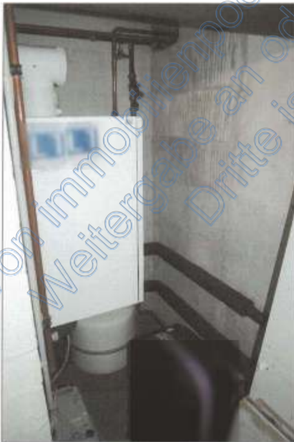
Foto 6 - Wohnhaus - Heiztherme im Hinterhaus KG
