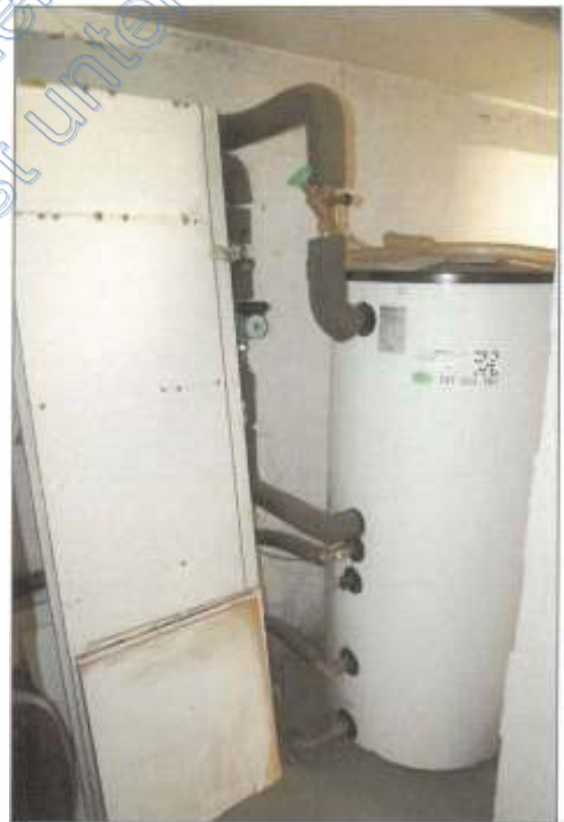
Foto 7 - Wohnhaus - Warmwasserspeicher im Hinterhaus KG
