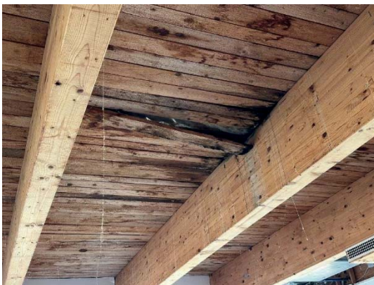
Decke/Dach über Hallenbad abbruchreif
