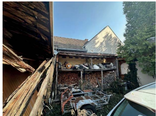
Wand zum östlichen Nachbar mit Regalen für Holzlagerung. Die Holzbauteile sind komplett vermorscht.
