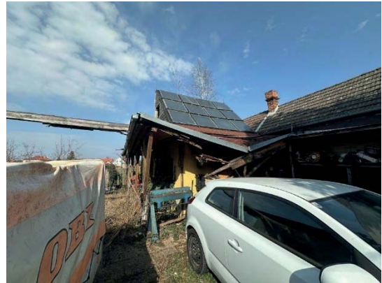
Zustand Nebengebäude. Aus dem Dach wächst ein Baum.
