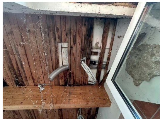
Vorhandene Einbauten im Dach bauphysikalisch nicht korrekt ausgeführt. Abbruchreif.
