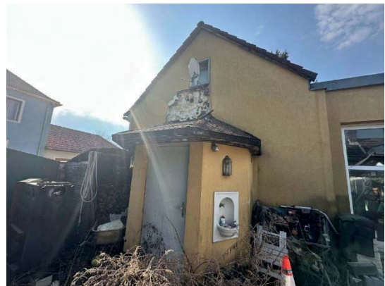
Brandschaden (?) über dem Dach des Zubaus (Heizraum).
