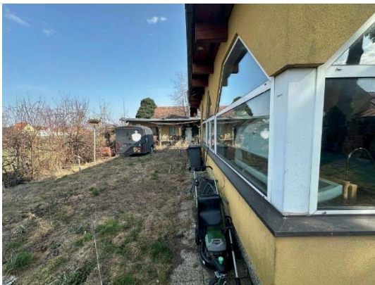
Außen: zahlreiche Kotreste, Begehung problematisch, Außenanlage nicht vorhanden
