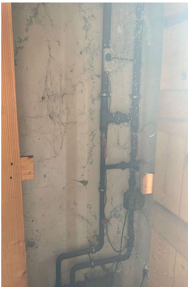
Heizungsrohre mit Umwälzpumpe im Aufenthaltsbereich des Stüberls
