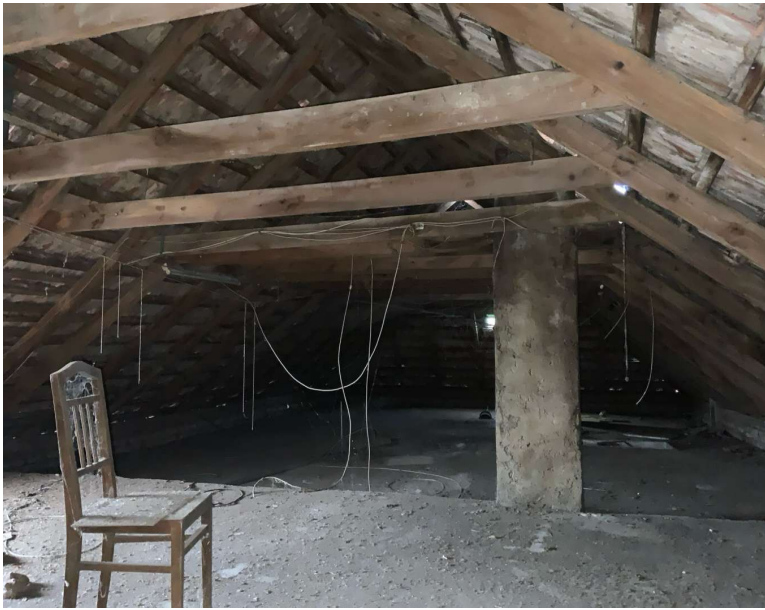
Roh-Dachboden ohne Isolierung, mäßiger Zustand der Dachziegel
