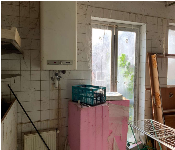
Elektroboiler im Abstellbereich hinter der Schank
