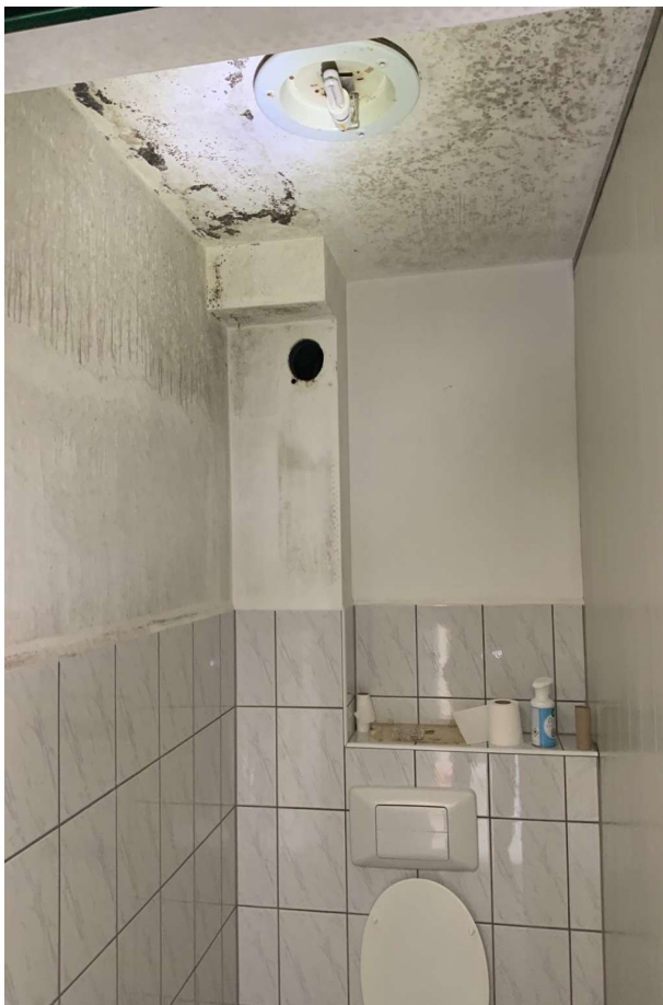
WC mit Schimmelbefall an der Decke
