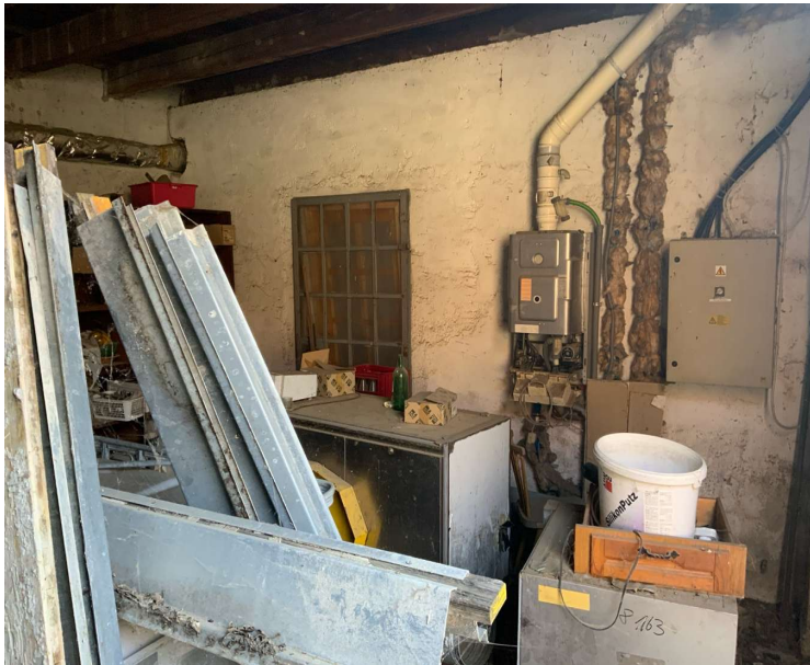
Werkstattbereich mit Elektro-Schaltschrank – Funktion nicht überprüft
