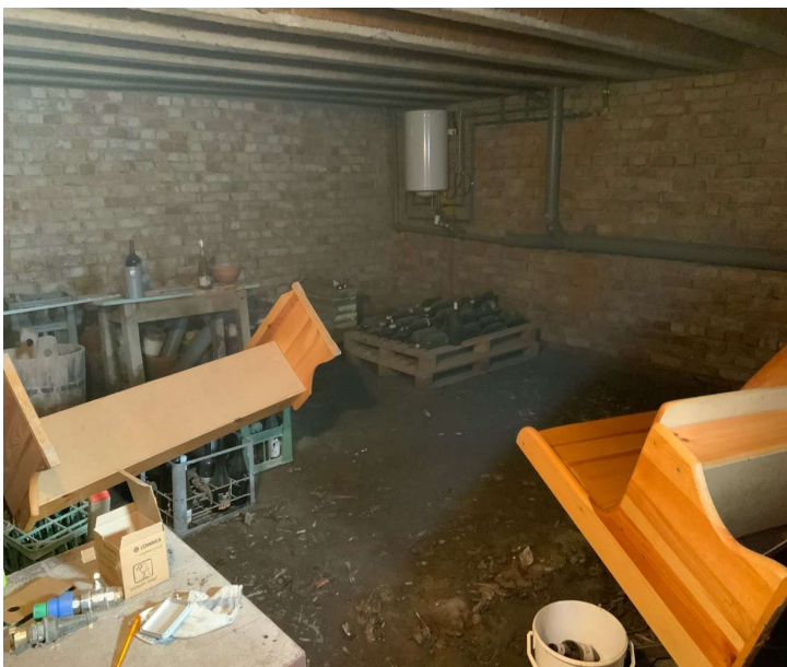
Kellergeschoss unter Ausnehmerwohnung mit Wasserboiler – Foto 2
