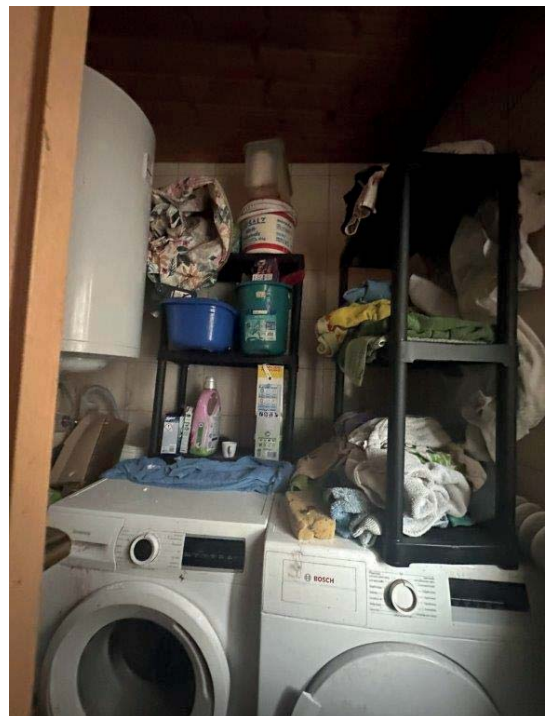
Bad mit Warmwasserspeicher
