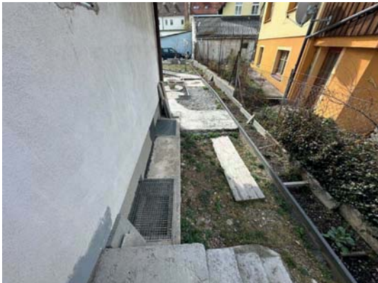
Zugang nicht fertig – kein Bodenbelag
