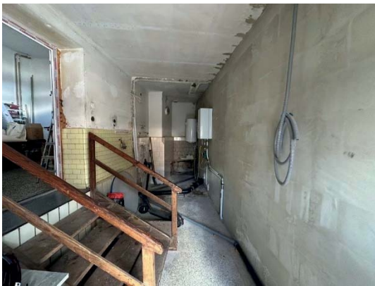
Abstellraum mit Haustechnik
