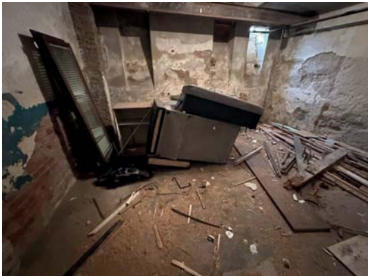
Keller Putzflecken, aufsteigende Feuchtigkeit
