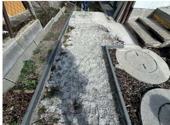
Zugang nicht fertig
