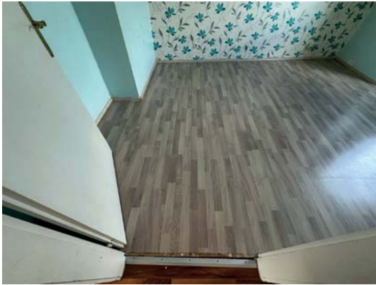
Top 2: Boden unsauberer Übergang
