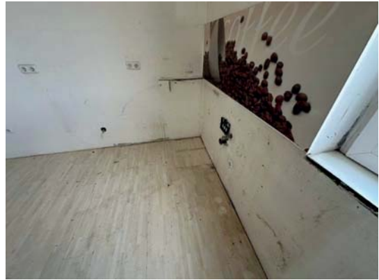
Top 2: Wände abgenutzt, Böden abgenutzt
