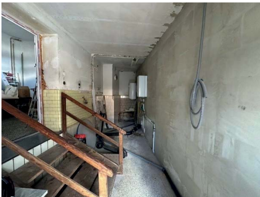
Abstellraum Wände nicht gemalt
