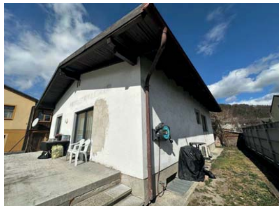
Terrasse nicht fertig und Putzflecken Fassade
