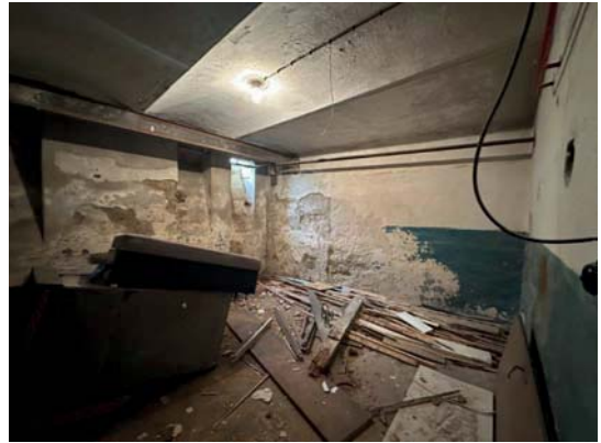
Keller Putzflecken, aufsteigende Feuchtigkeit
