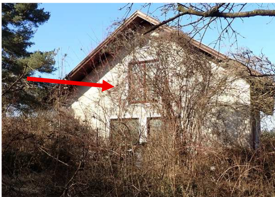
Absturzssicherung bei südseitiger Balkontüre im Dachgeschoß fehlend
