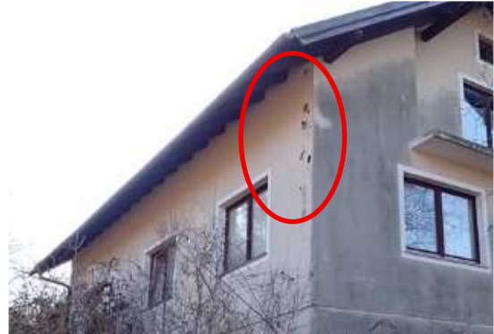
Schäden an Fassade durch Specht
