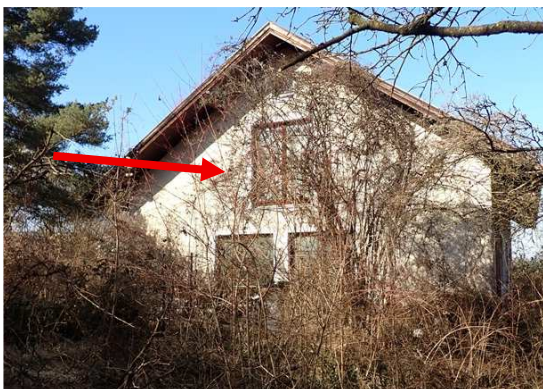
Absturzsicherung bei südseitiger Balkontüre im Dachgeschoß fehlend
