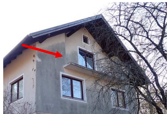
Fehlende Absturzsicherung/Balkongeländer bei nordseitigem Balkon im Dachgeschoß
