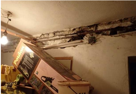
Elektrische Leitungen und Wasserleitung im Kellergeschoß tlw. neu eingestemmt, nicht verputzt
