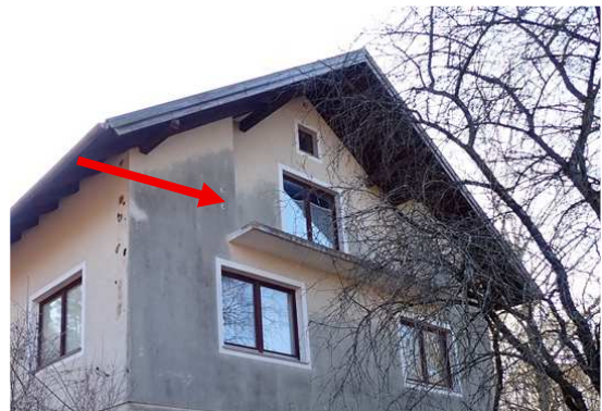
Fehlende Absturzsicherung/Balkongeländer bei nordseitigem Balkon im Dachgeschoß
