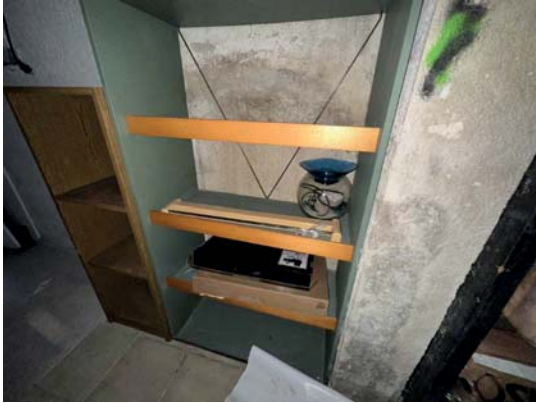
Bild 1: Feuchte Wände Keller
