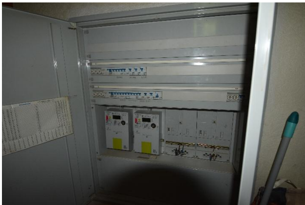
Foto 9: Zähler- und Sicherungskasten
