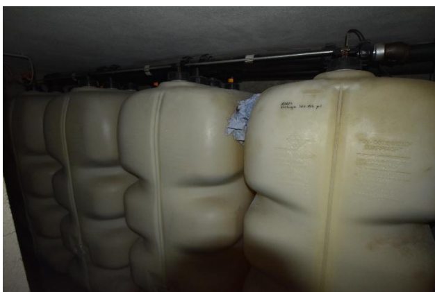
Foto 31: Wohnhaus KG – Tankraum
