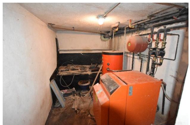
Foto 32: Wohnhaus Kellergeschoss – Heizraum
