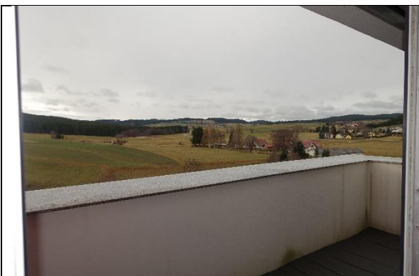
Balkon: Balkon: Boden: WPC Dielen (instandsetzungsbedürftig-Aufwerfungen); massive Brüstungswand mit Granitfliesenabdeckung;
