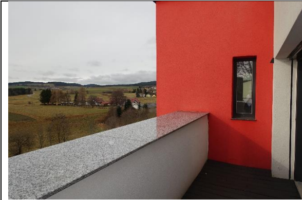
Balkon: Boden: WPC Dielen (instandsetzungsbedürftig-Aufwerfungen); massive Brüstungswand mit Granitfliesenabdeckung;
