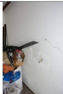
erkennbare Feuchtigkeitsschäden an der südöstlichen Außenwand;
