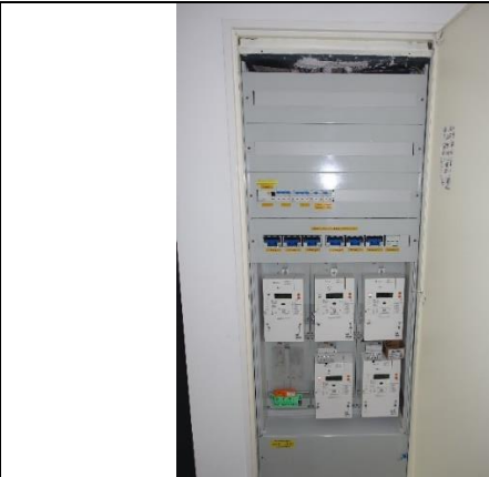
Elektrohauptverteiler und Zählerschrank:
