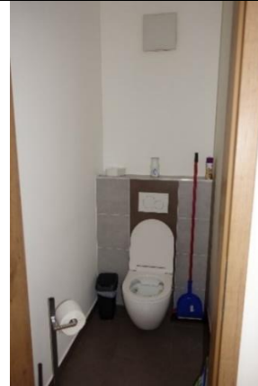
WC: Boden: Fliesen; Wände: teilw. verputzt bzw. gespachtelt und gemalt, teilw. Fliesen; Decke: verputzt bzw. gespachtelt und gemalt; Sanitär-ausstattung: 1 Hänge-WC mit Unterflurspülkasten; 1 Elektrolüfter;
