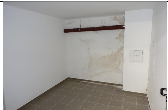
Abteil 1: Boden: Fliesen; Wände und Decke: verputzt und gemalt; erkennbare Feuchtigkeitsschäden an der nordwestlichen Außenwand
