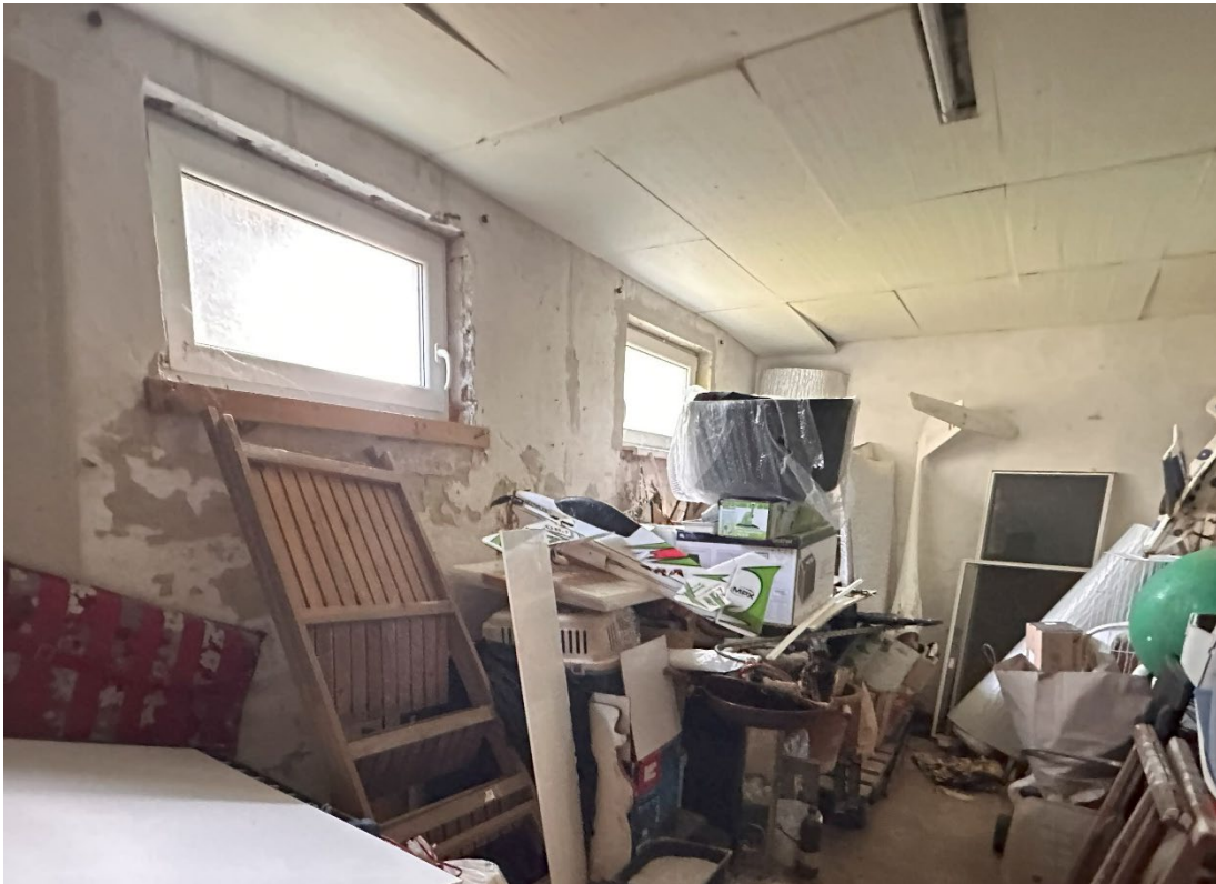
Foto 3: Wasserflecken an der Kellerwand | Wärmedämmung der Kellerdecke zum Erdgeschoß
