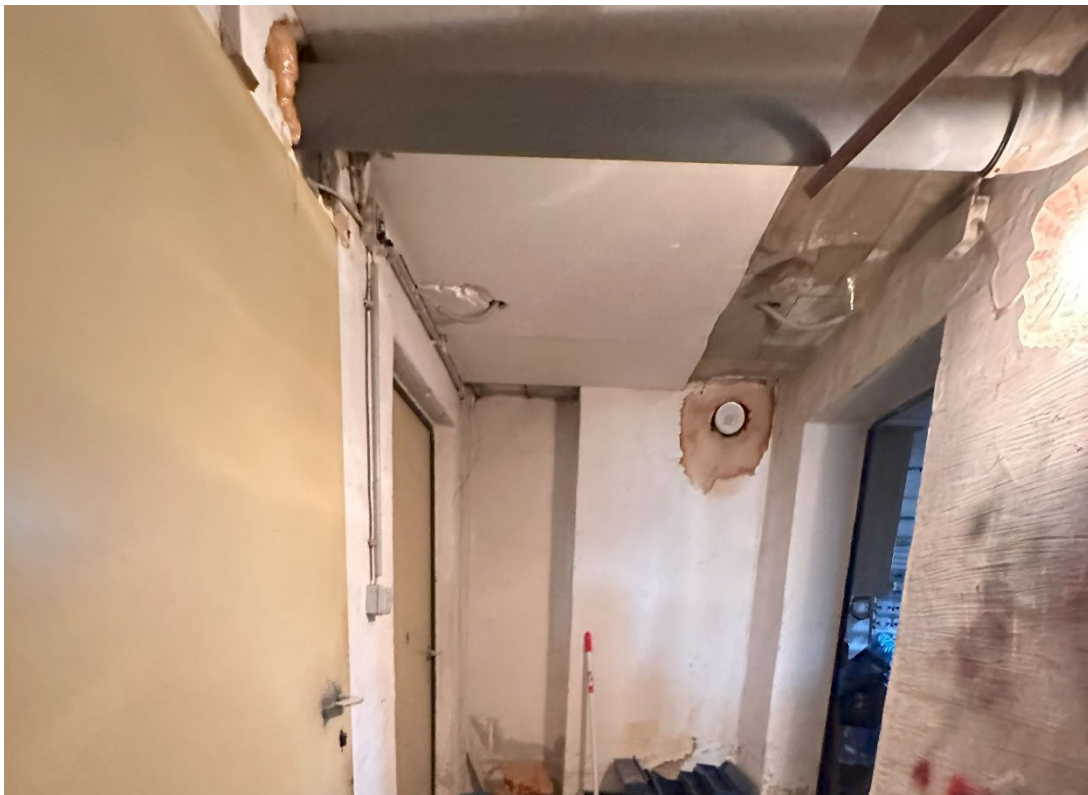
Foto 4: Wasserflecken an der Kellerwand
