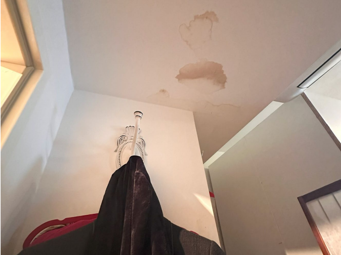
Foto 3: Wohnung Top D 3 | Wasserschaden Zimmer
