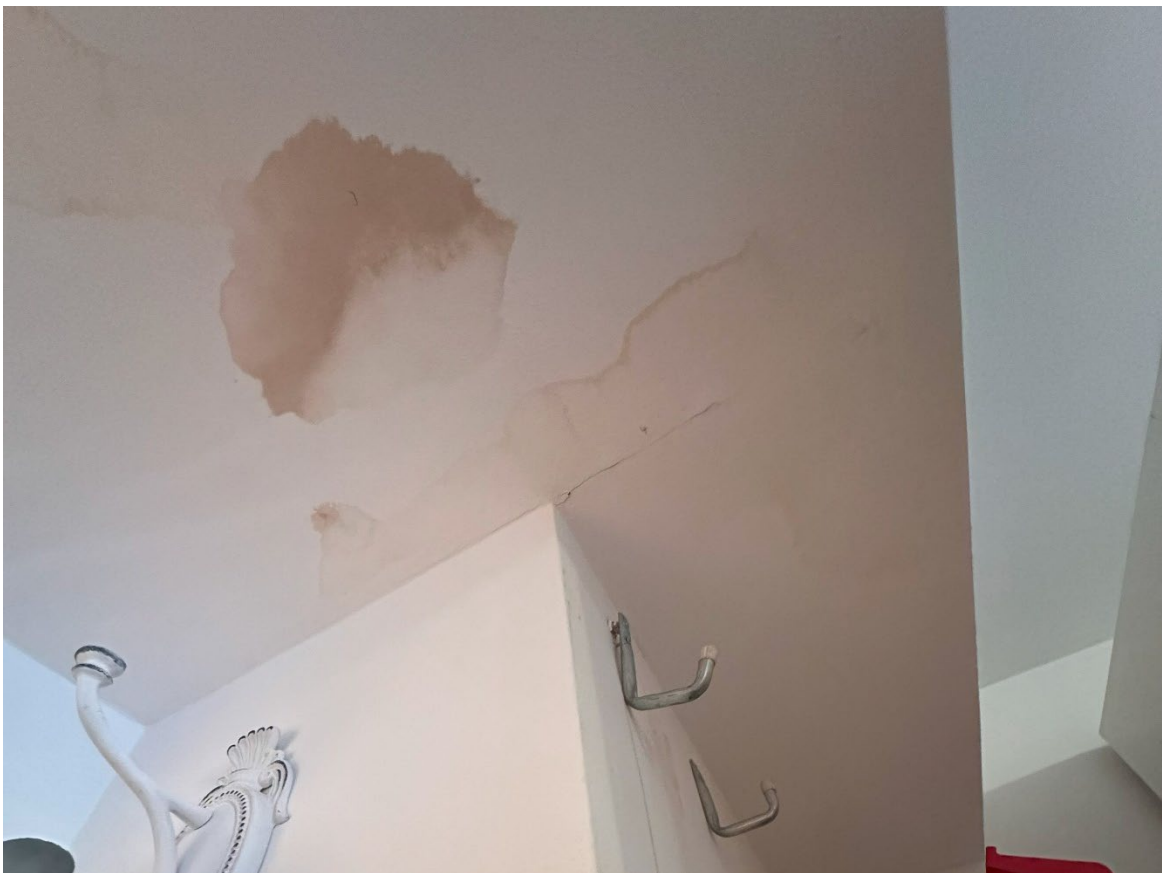
Foto 4: Wohnung Top D 3 | Wasserschaden Zimmer
