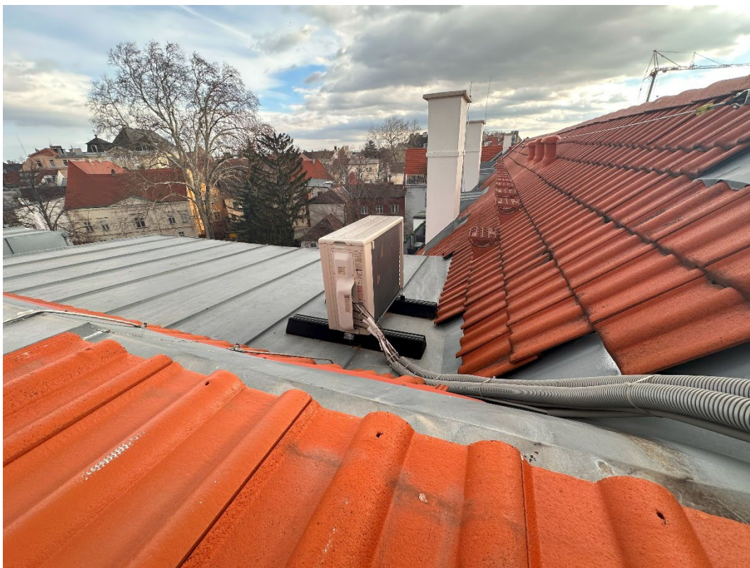
Foto 32 Top D 3 | Dach und Klimagerät
