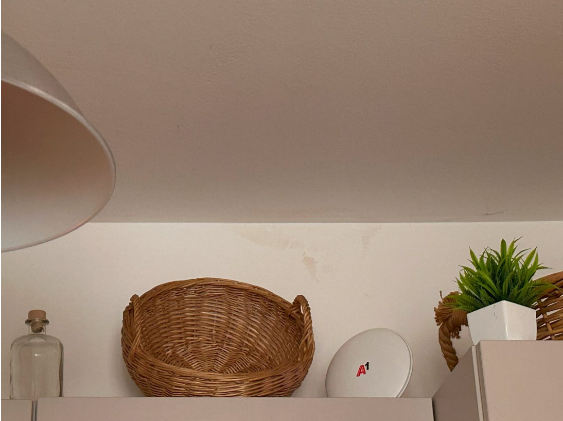
Foto 1: Wohnung Top D 3 | Wasserschaden Küche
