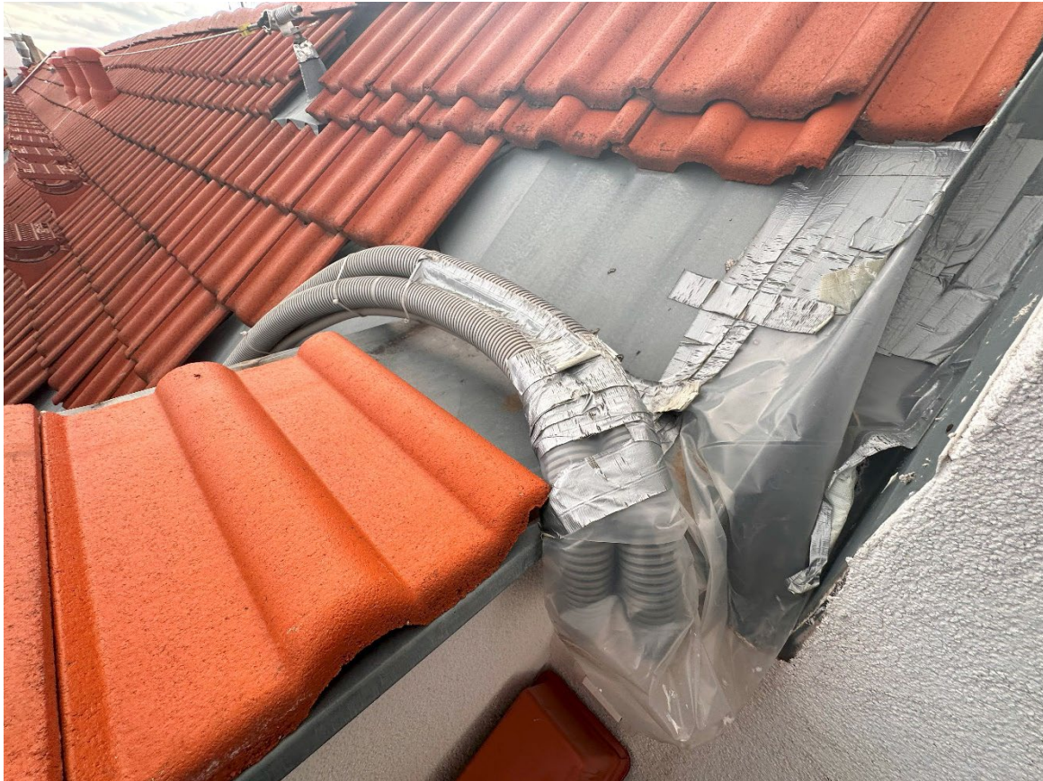
Foto 5: Wohnung Top D 3 | Anschluss Klimagerät
