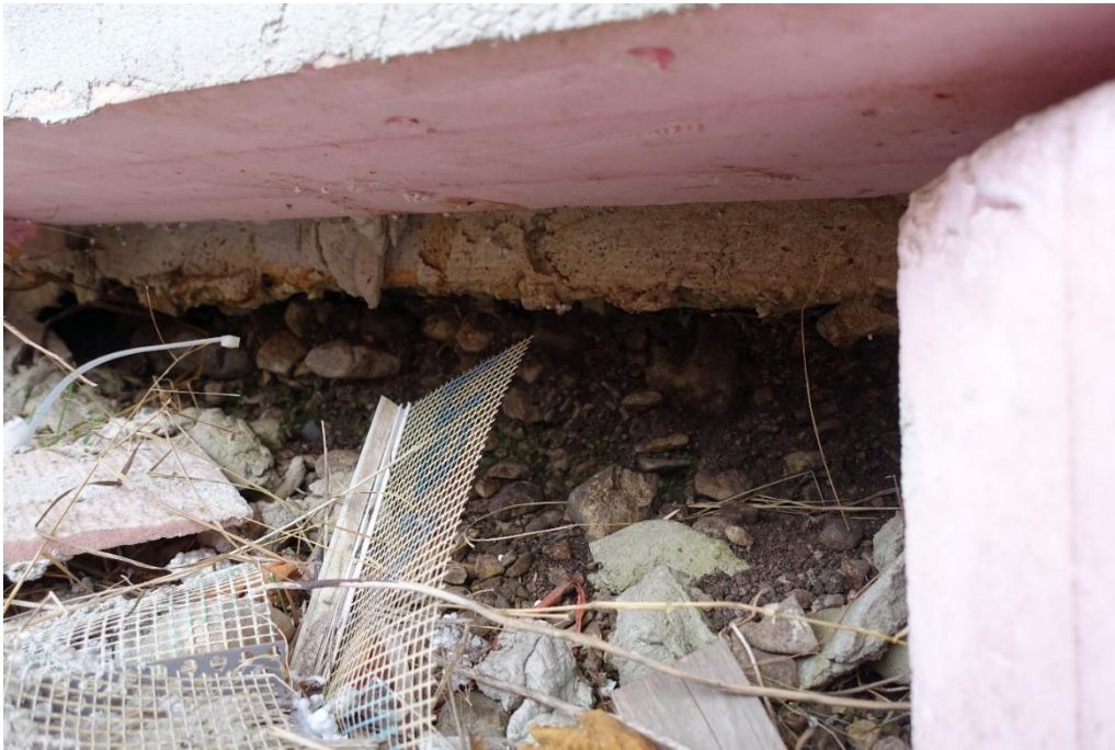
Foto 13 – Sockel Haus 1 (Nord-Westecke): keine Feuchtigkeitsisolierung ersichtlich
