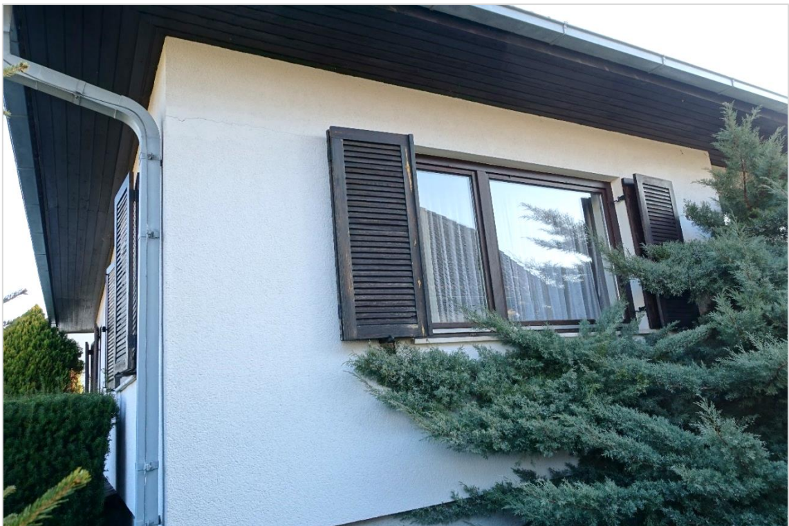
Foto 4 – Riss im Bereich der westlichen Hausecke
