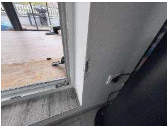
Beschädigte Wandkante in der Küche
