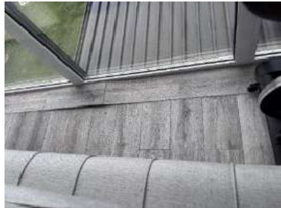
Beschädigte Fliesen im Wohnzimmer
