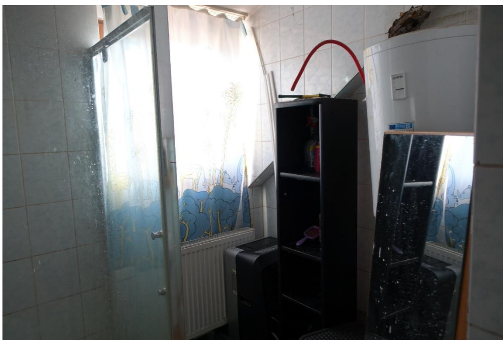
Foto 18 – Bad DG (Warmwasserspeicher)
