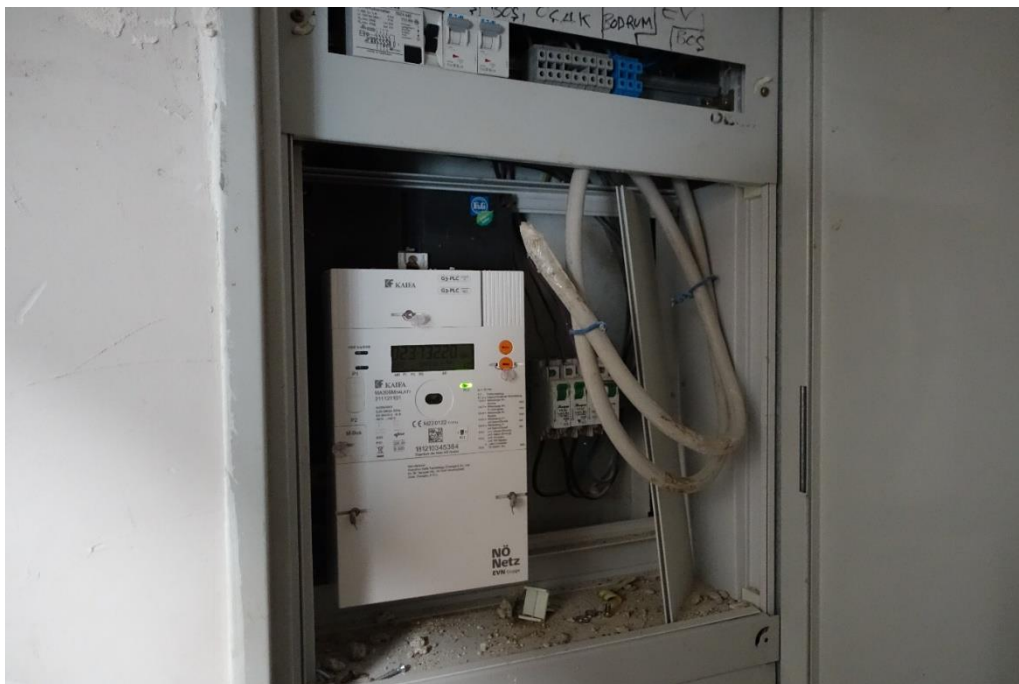
Foto 8 – E-Zählerkasten (Stiegenaufgang DG)
