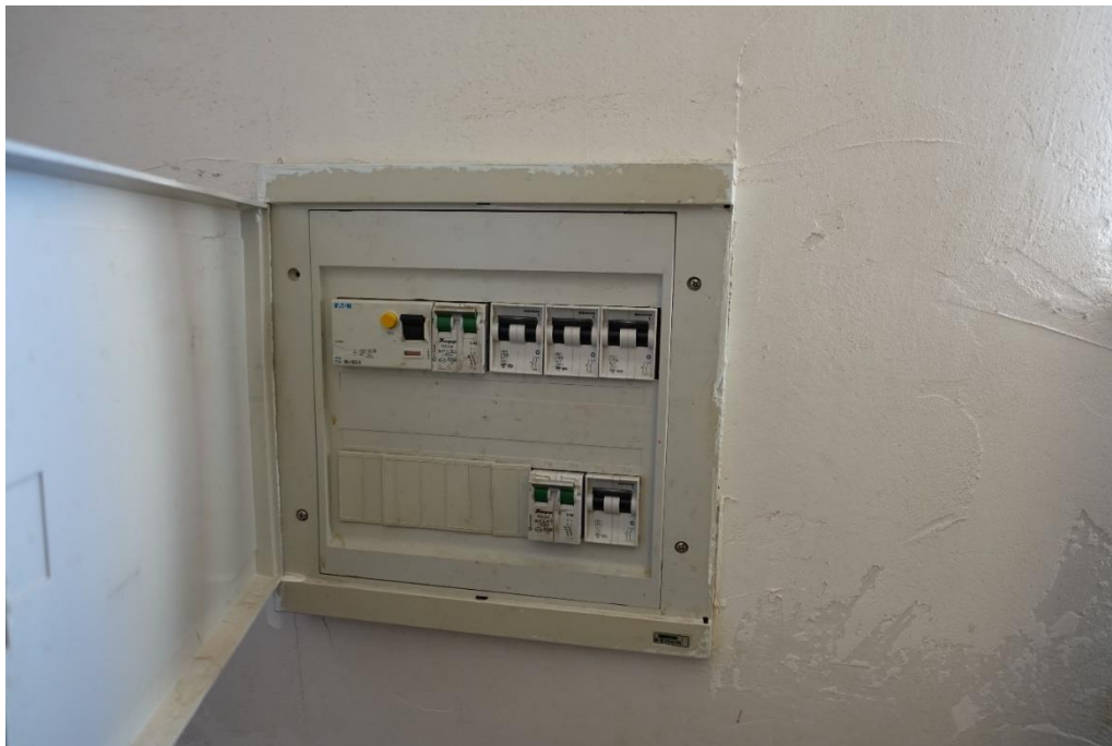
Foto 7 – E-Sicherungskasten (Stiegenaufgang DG)
