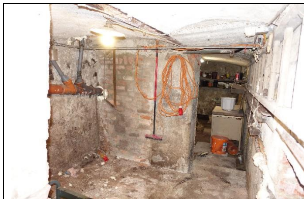
Keller 1: Boden: Beton; Wände: teilweise verputzt, teilweise Vollziegelmauerwerk unverputzt; Decke: Gewölbedecke verputzt; erkennbare Feuchtigkeitsschäden im Bereich Boden/Wand;
