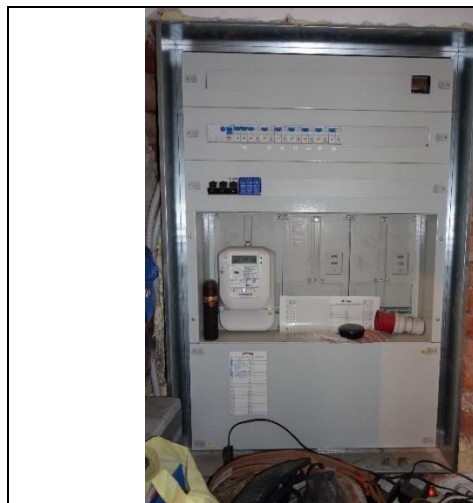
Elektroverteiler und Zählerschrank
