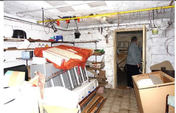
Keller 2: Boden Fliesen; Wände: verputzt und geweißt; Decke: Fertigteildecke geweißt; erkennbare Feuchtigkeitsschäden im Boden-Wandbereich;
