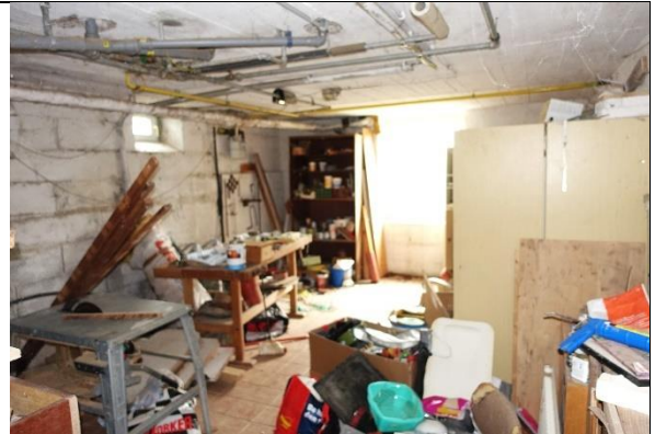
Einstellraum: Boden Fliesen; Wände: verputzt und geweißt; Decke: Fertigteildecke unverputzt; erkennbare Feuchtigkeitsschäden im Boden-Wandbereich;
