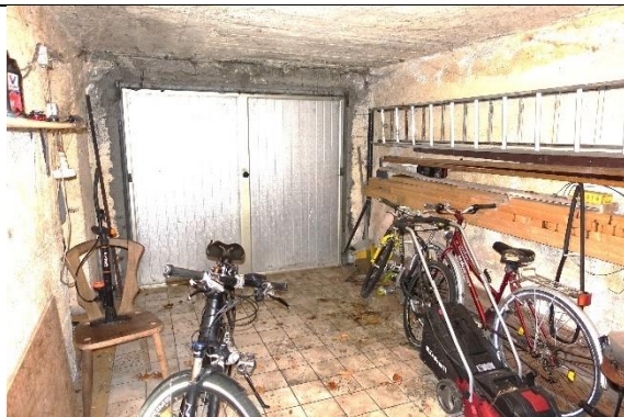
Abstellraum: Boden Fliesen; Wände: grob verputzt; Decke: Stahlbetondecke; 1 Stahlblechkippotor mit manuellem Antrieb; erkennbare Feuchtigkeitsschäden im Boden-Wandbereich;
