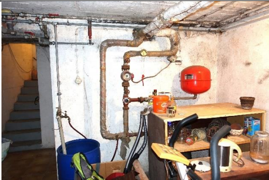
Keller 1: Boden Fliesen; Wände: verputzt und geweißt; Decke: Fertigteildecke unverputzt; erkennbare Feuchtigkeitsschäden im Boden-Wandbereich;
