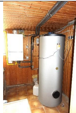
Warmwasserspeicher (Fassungsvermögen 385 l); 1 Erdgas-Außenwandtherme (Fabr. Vaillant)
